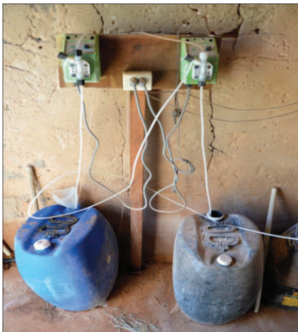
Foto 107: – Bombas Dosadoras e Produtos Químicos – Poço P9 Localização: – Colina Verde
