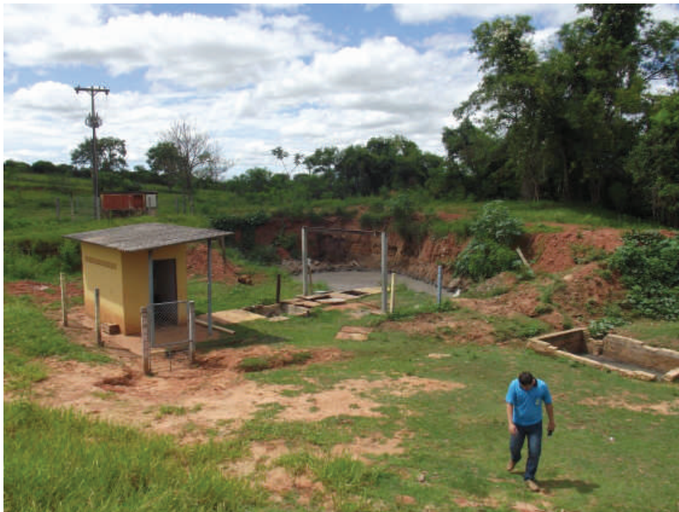
Foto 179: – Local Estação Elevatório de Esgoto (Vista Aérea) Localidade: Estação Elevatória de Esgoto – Santa Rosa
