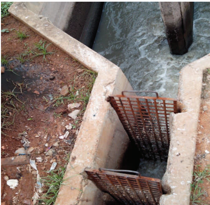
Foto 173: – Calha Parshall - Gradeamento Localização: Estação Elevatória de Esgoto Ribeirão Conchal
