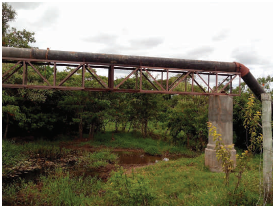
Foto 177: – Passagem Aérea do Emissário de Esgoto Sobre o Ribeirão Conchal Localização: Estação Elevatória de Esgoto Ribeirão Conchal
