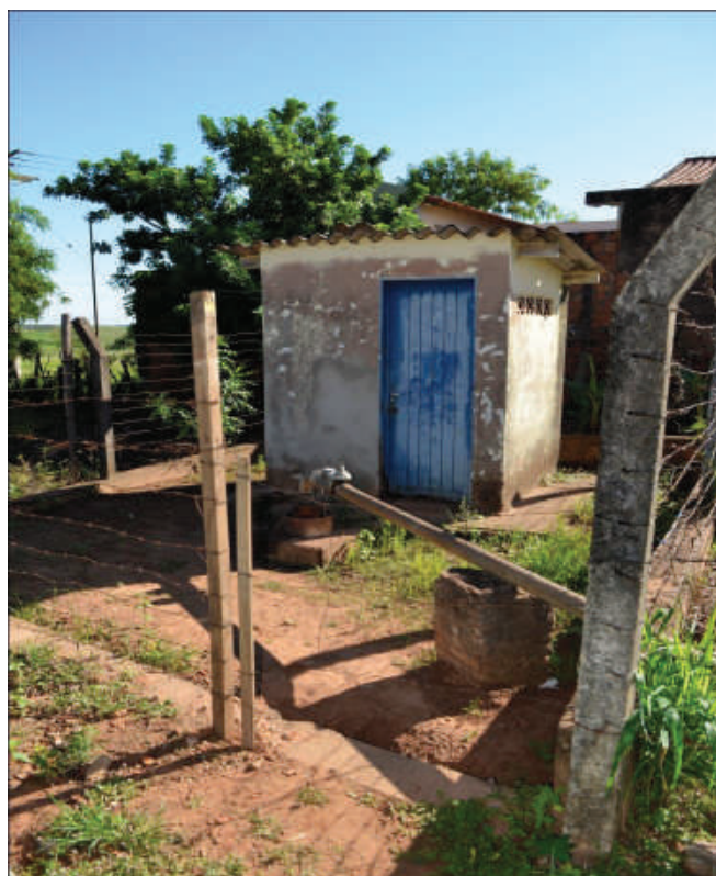
Foto 90: – Entrada do Poço, Local do Armazenamento dos Produtos Químicos e Painel Elétrico – Poço P4 Localização: Jardim Santa Rosa
