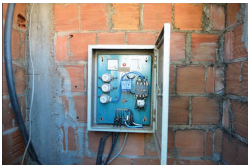
Foto 125: – Painel De Comando Localização: Bairro Amandaba
