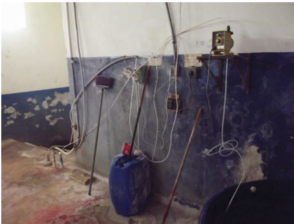
Foto 71: – Bombas Dosadoras para Aplicação do Ácido Fluorsilícico e Orto-Polifosfato (Econox) Localização: ETA – Estação de Tratamento de Água
