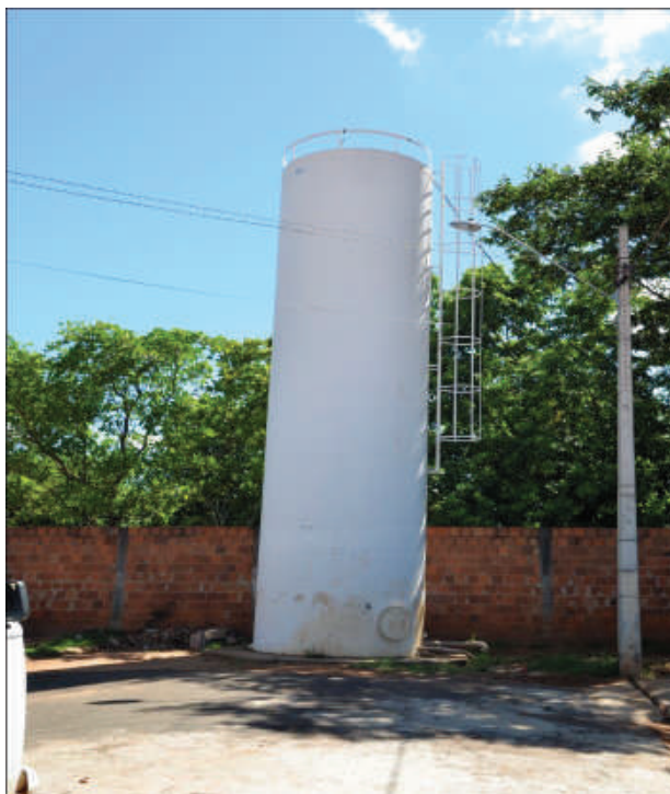
Foto 31: – Reservatório Vale do Sol - Capacidade: 50m 3 Localização: Rua José Benedito Bragaia, s/nº
