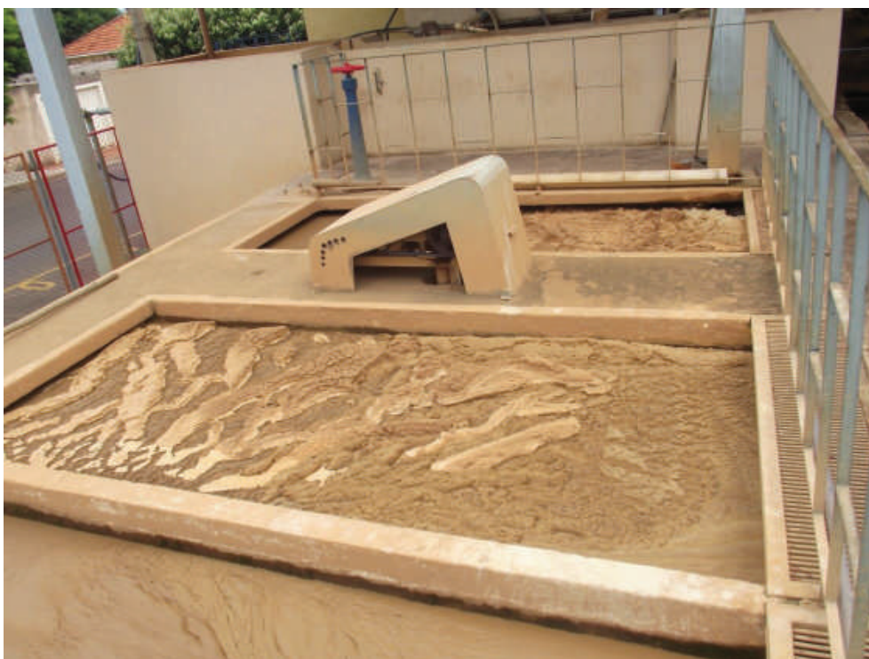
Foto 63: – Local onde é Feito a Flocculação da Água Bruta e Batedouros Localização: ETA – Estação de Tratamento de Água
