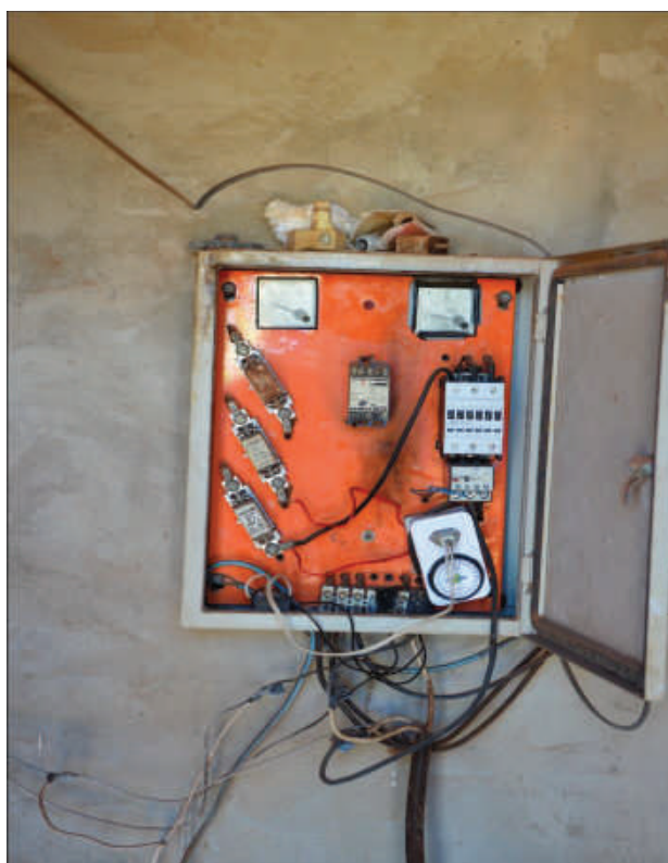
Foto 118: – Painel Elétrico do Poço - P20 Localização: CDHU / Sonho Meu
