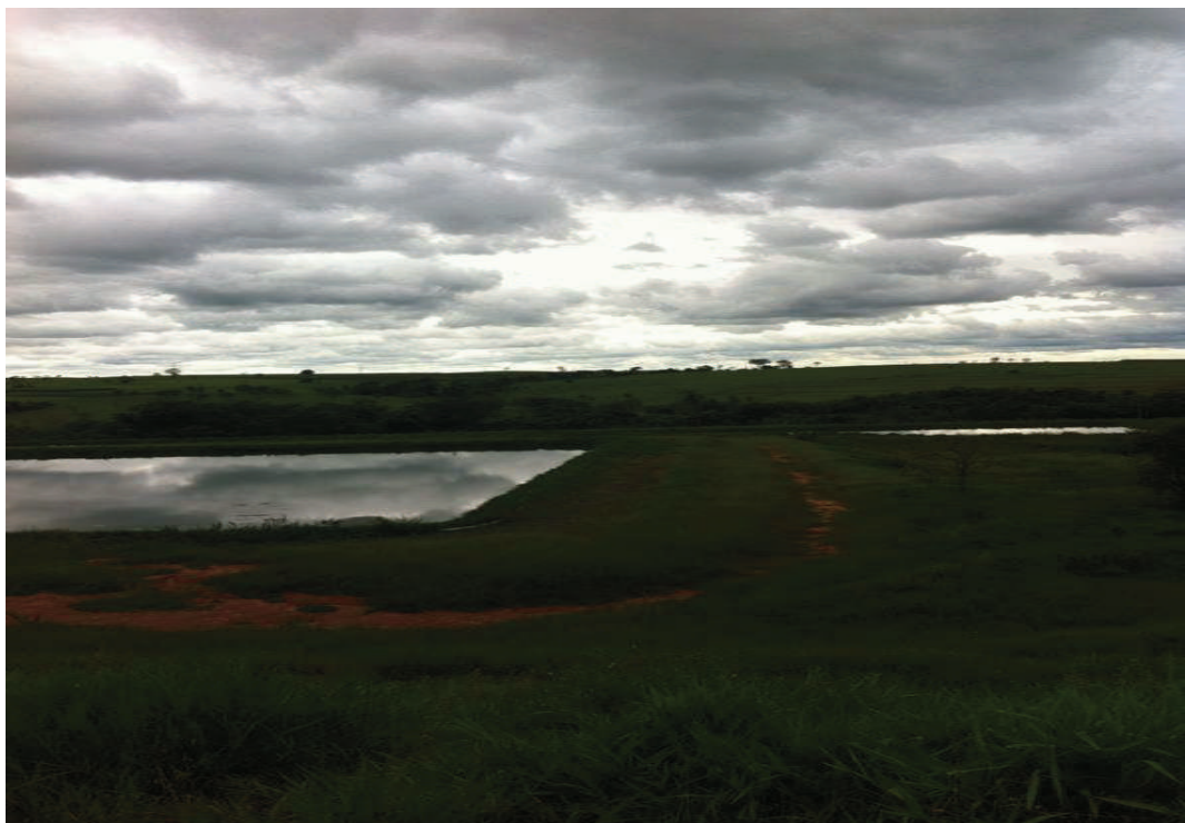
Foto: 195 – Vista da 1ª Lagoa de Tratamento de Esgoto e ao Fundo 2ª Lagoa de Tratamento Localização: ETE – Estação de Tratamento de Esgoto de Mirandópolis
