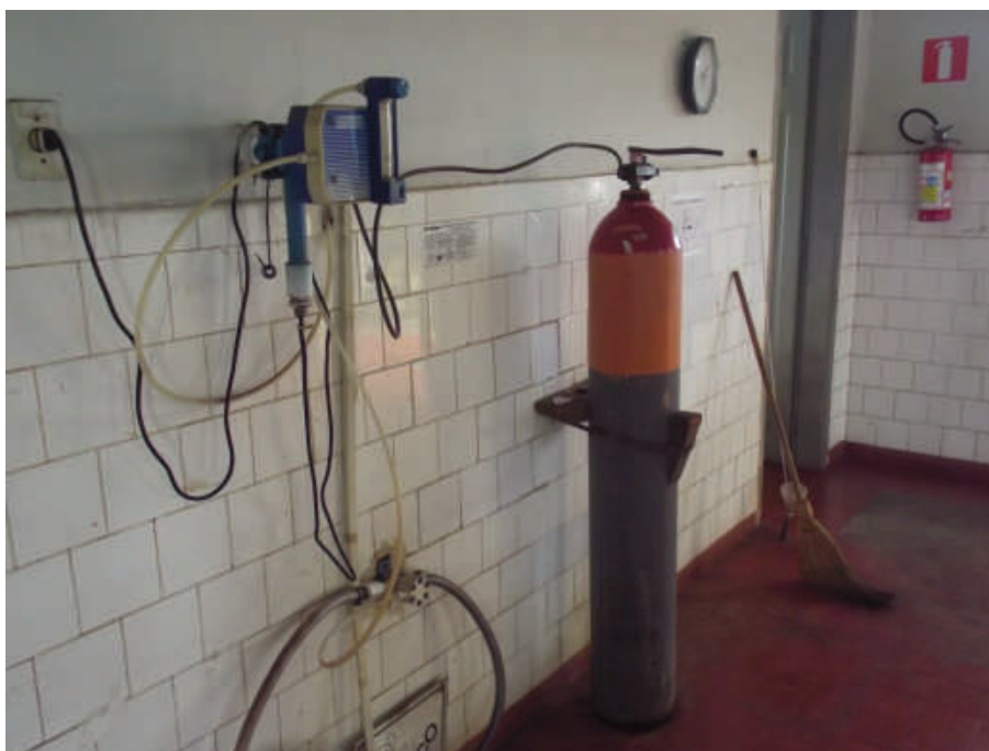
Foto 69: – Bojões para Aplicação do Gás Cloro Para o Tratamento Localização: ETA – Estação de Tratamento de Água
