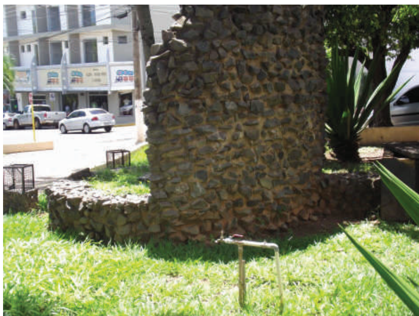
Foto 12: – Fotos Cavalete Sem Hidrômetro
