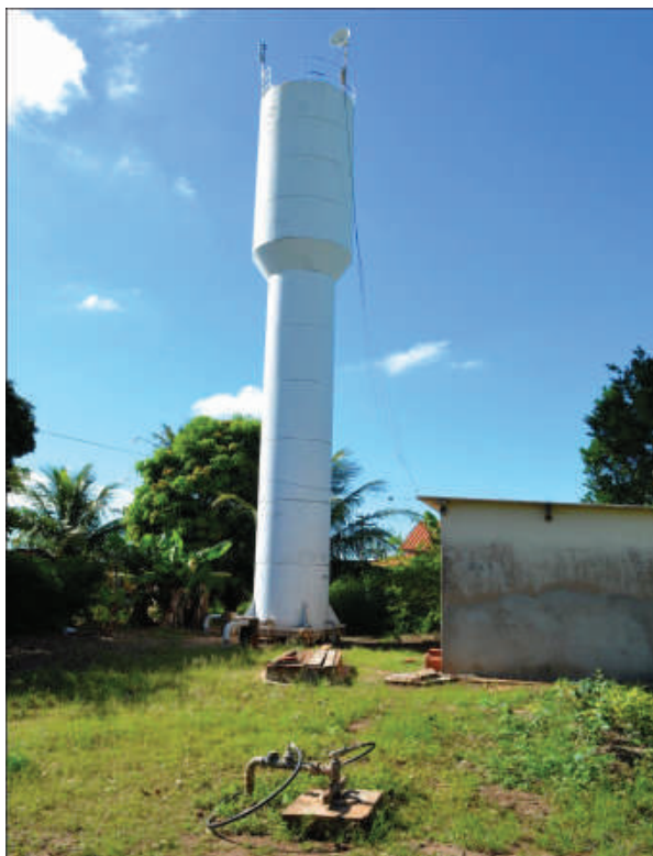
Foto 32: – Reservatório do Bairro Amandaba - Capacidade: 50m 3 Localização: Rua Brasil, nº 50
