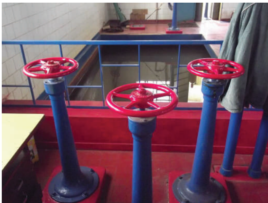
Foto 68: – Registros dos Filtros de Tratamento Localização: ETA – Estação de Tratamento de Água
