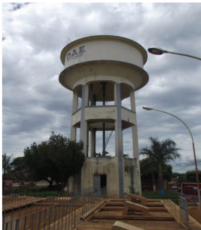
Foto 16: – Reservatório Elevado - ETA – Capacidade de 200m 3 Localização: Rua Ana Luiza da Conceição, nº 510
