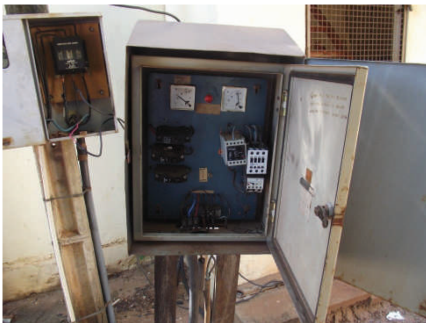
Foto 128: – Painel de Comando - Poço do Bairro Primeira Aliança – P1 Localização: Primeira Aliança
