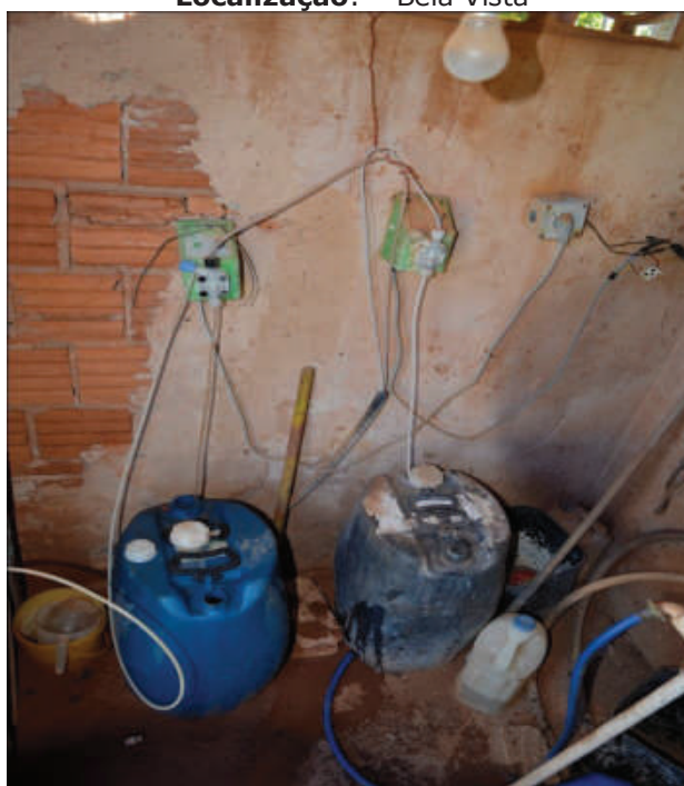
Foto 98: - Bombas Dosadoras e Produtos Químicos - Poço P7 Localização: - Bela Vista
