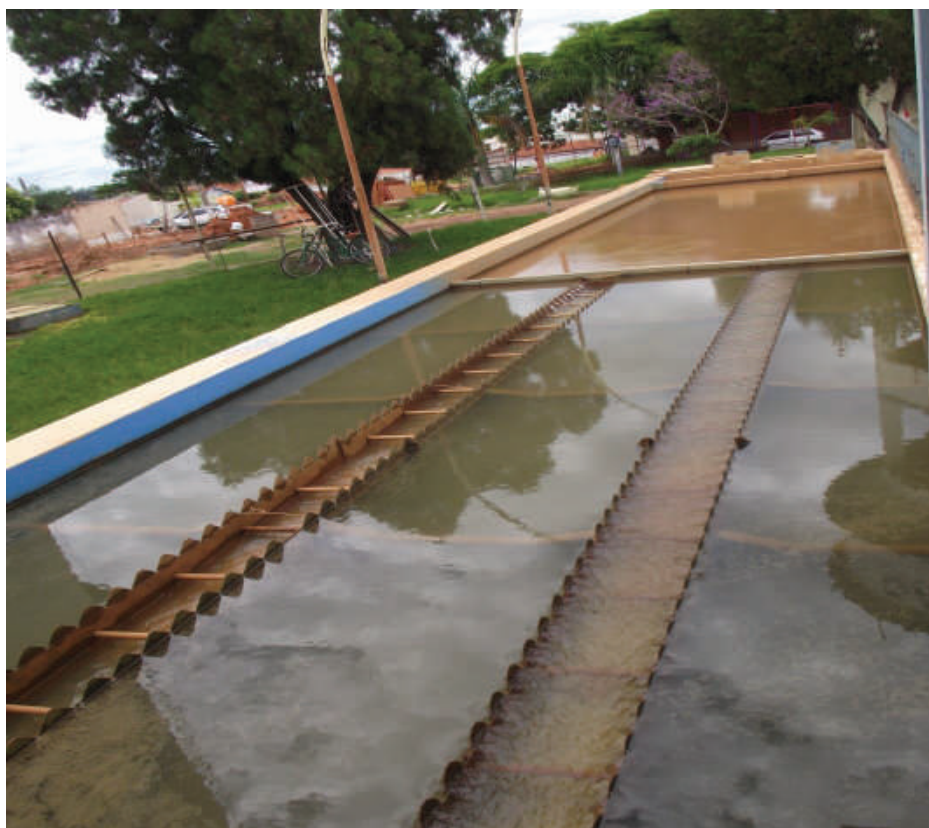
Foto 65: – Entradas dos Filtros para Tratamento Localização: ETA – Estação de Tratamento de Água
