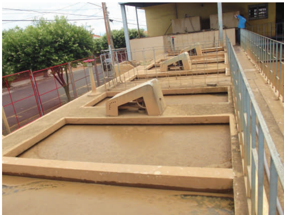
Foto 64: – Local onde é Feito a Flocculação da Água Bruta e Batedouros Localização: ETA – Estação de Tratamento de Água
