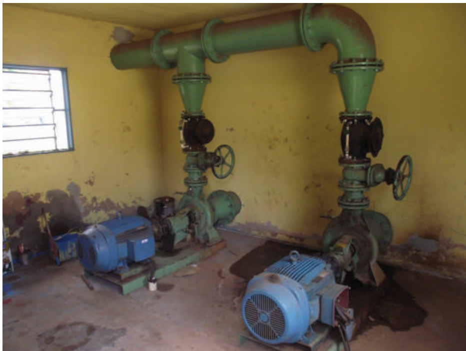
Foto 60: – Motores que Fazem o Recalque da Água Tratada para os Reservatórios Elevados Localização: ETA – Estação de Tratamento de Água
