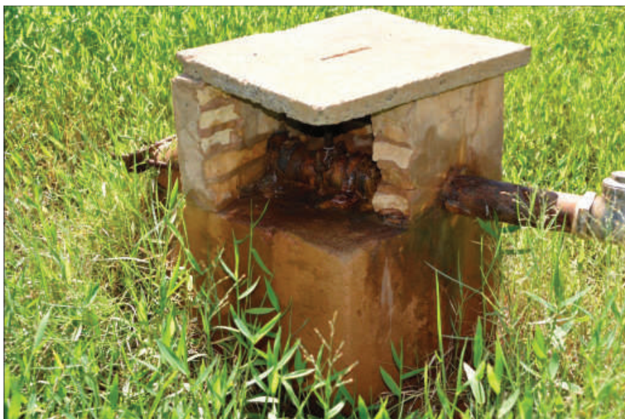
Foto 78: – Local onde é Feito a Dosagem (Tratamento) – Hipoclorito de Sódio e Ácido Fluorsilícico Poço P1 Localização: Jardim Aeroporto.
