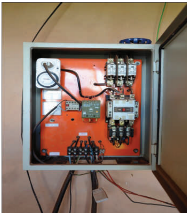
Foto 114: – Painel de Comando – Poço P13 Localização: – Jardim Sampaio
