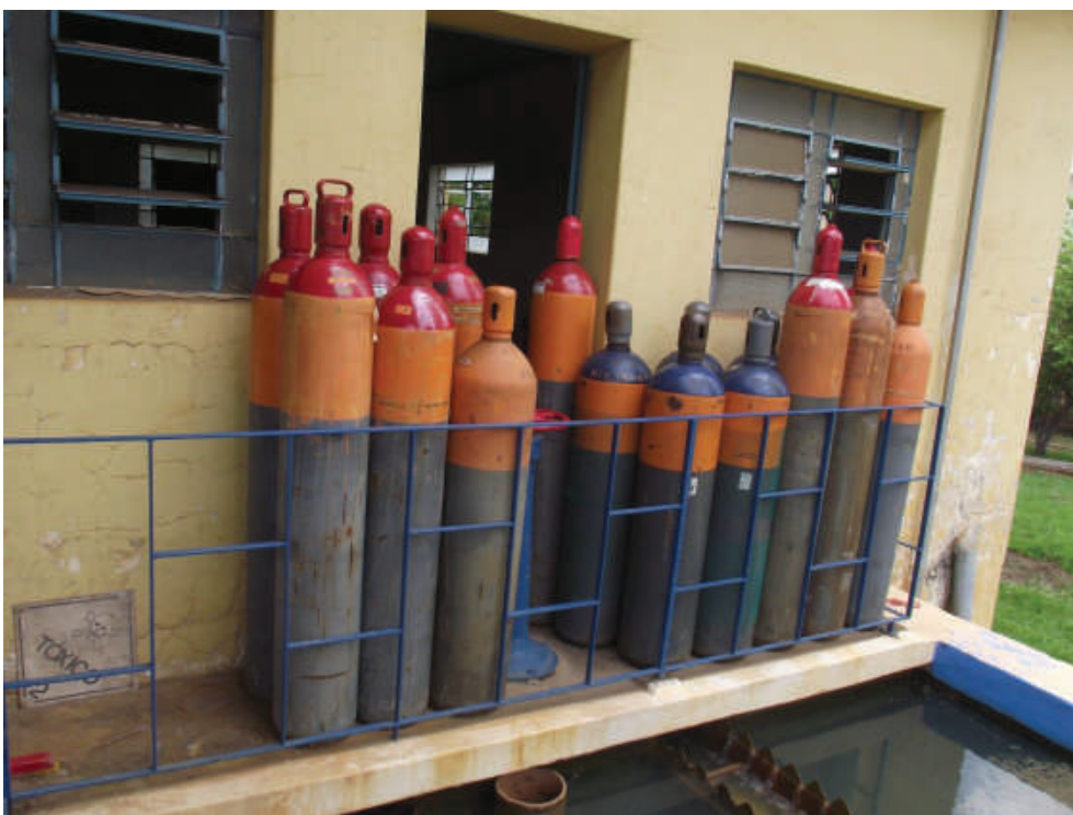
Foto 73: – Local onde é Armazenado os Bujões de Gás Cloro Localização: ETA – Estação de Tratamento de Água
