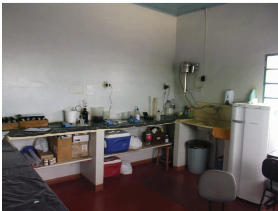
Foto 75: – Laboratório de Análises Químicas Localização: ETA – Estação de Tratamento de Água
