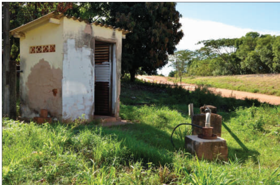
Foto 95: – Entrada do Poço – P7, Casa de Armazenamento dos Produtos Químicos, Bombas Dosadoras e Painel Elétrico – Poço P7 Localização: – Bela Vista
