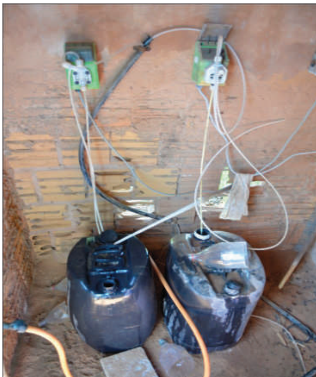
Foto 85: – Bombas Dosadoras e Galões Produtos Químicos - Poço P2 Localização: Casa da Criança.
