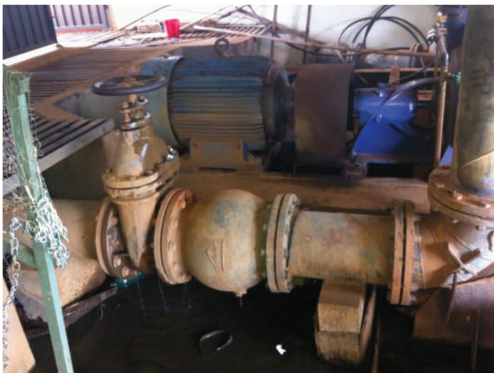
Foto 46: – Registros, Motor e Bomba da Captação da Água Bruta Localização: Barragem Santa Helena
