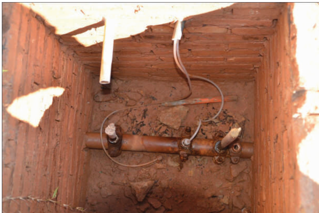
Foto 116: – Local onde é Feito a Dosagem de Cloro e Flúor para Tratamento da Água- Poço P13 Localização: – Jardim Sampaio
