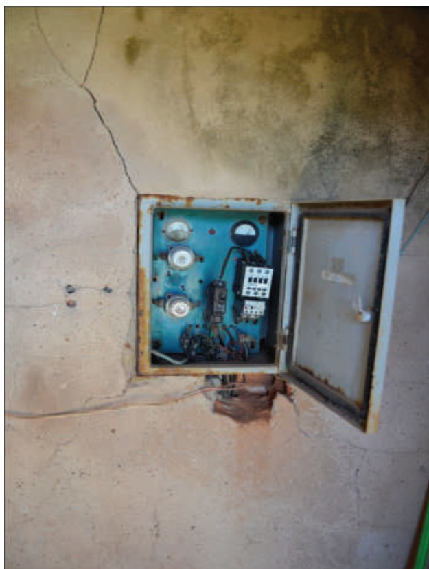
Foto 106: – Painel de Comando do Poço P9 Localização: – Colina Verde
