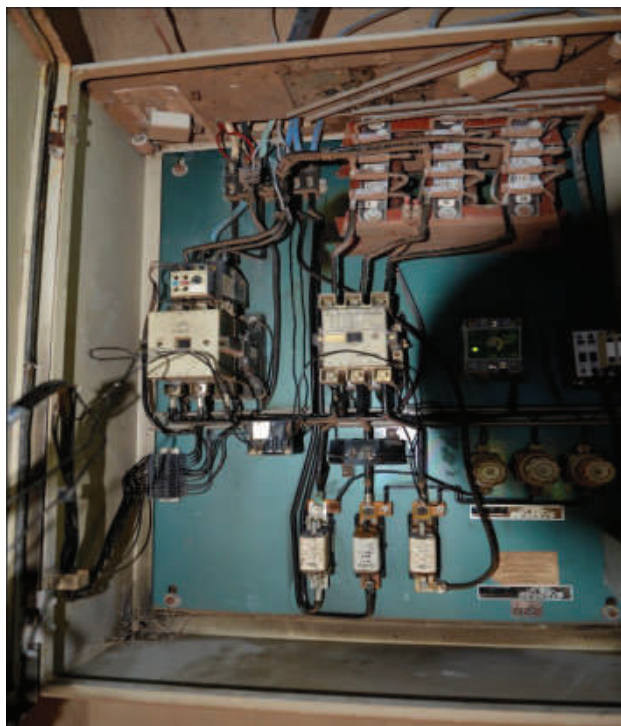
Foto 86: – Painel de Controle de Partida – Poço P3 Localização: São Lourenço.
