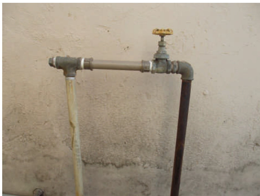
Foto 11: – Fotos Cavalete Sem Hidrômetro
