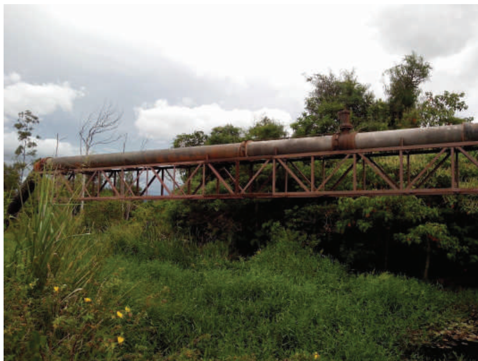
Foto 178: – Passagem Aérea do Emissário de Esgoto Sobre o Ribeirão Conchal Localização: Estação Elevatória de Esgoto Ribeirão Conchal
