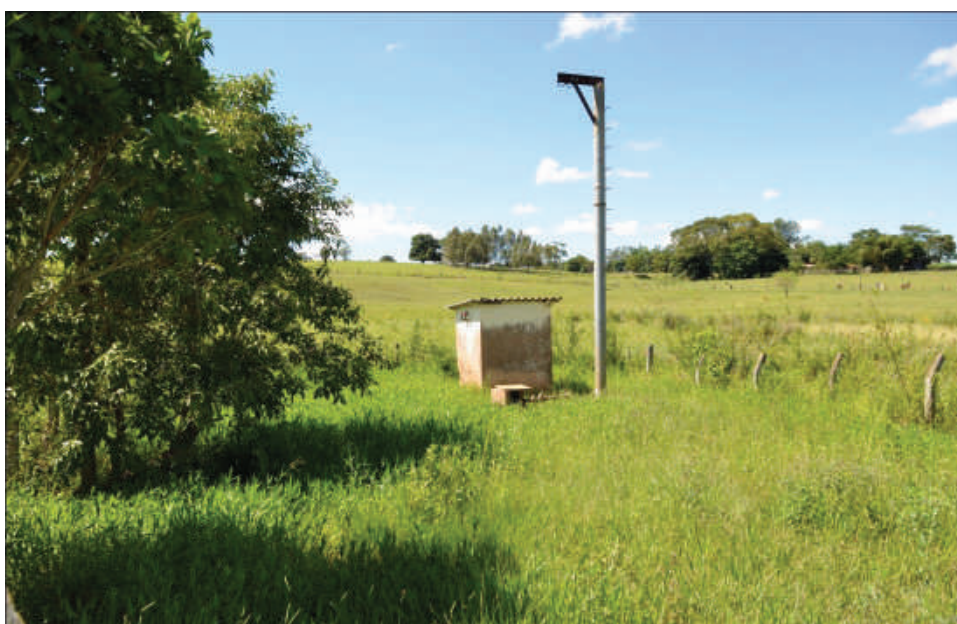
Foto 80: – Local de Armazenamento dos Produtos Químicos, Bombas Dosadoras e Painel Elétrico Poço - P1
