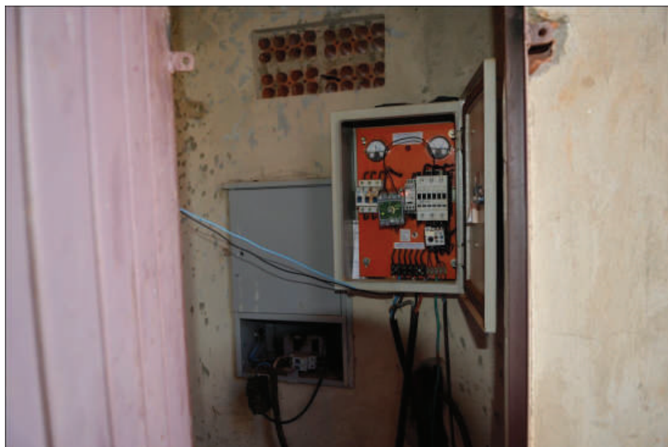
Foto 120: – Painel de Comando – Poço P18 Localização: Vale do Sol
