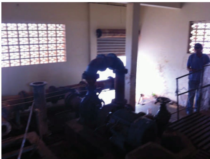
Foto 44: – Motor e Bomba da Captação da Água Bruta Localização: Barragem Santa Helena
