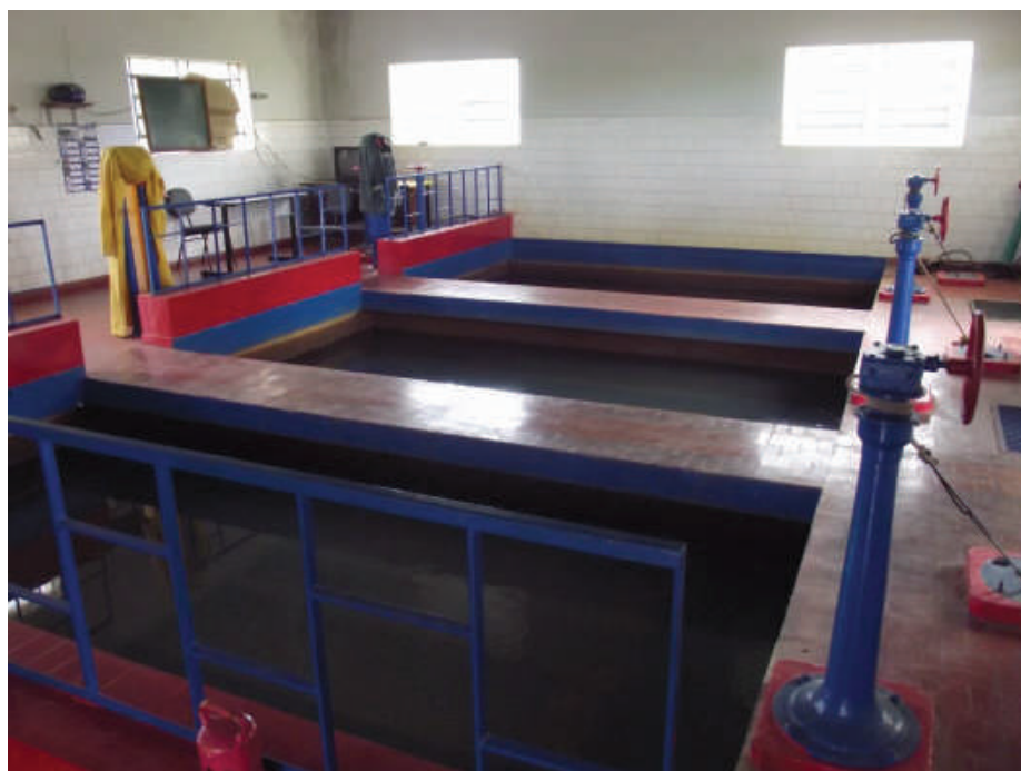
Foto 66: – Filtros do Tratamento e Registros Localização: ETA – Estação de Tratamento de Água
