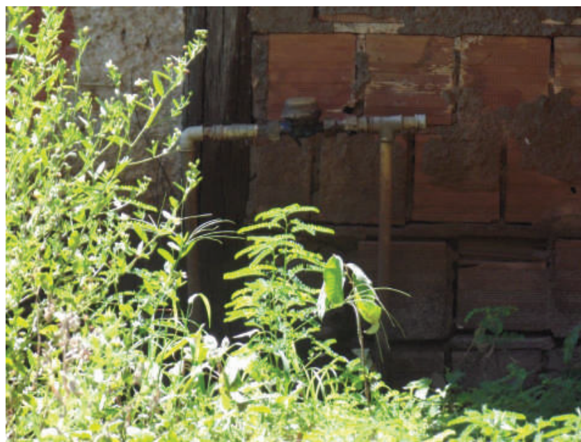
Foto 139: – Hidrômetro e Cavalete Localização: Bairro Terceira Aliança ( Único Bairro Hidrometrado )
