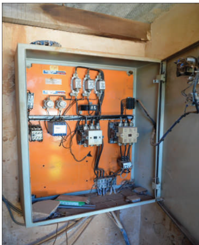
Foto 97: -Painel de Comando - Poço P7 Localização: - Bela Vista
