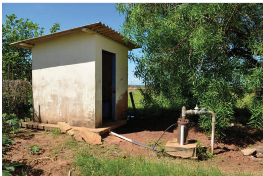
Foto 99: – Casa de Armazenamento dos Produtos Químicos, Bombas Dosadoras e Entrada do Poço P12
