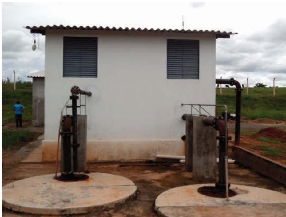
Foto 170: – Bombas de Recalque (Vista Lateral) Localização: Estação Elevatória de Esgoto Ribeirão Conchal
