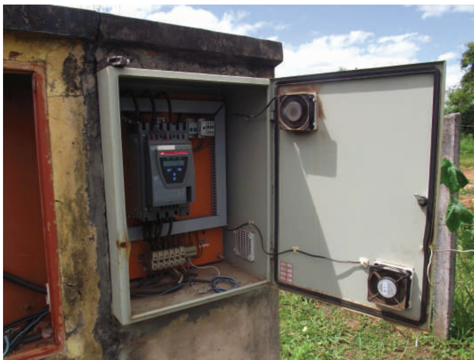
Foto 181: – Painel de Comando Elétrico Localidade: Estação Elevatória de Esgoto – Santa Rosa
