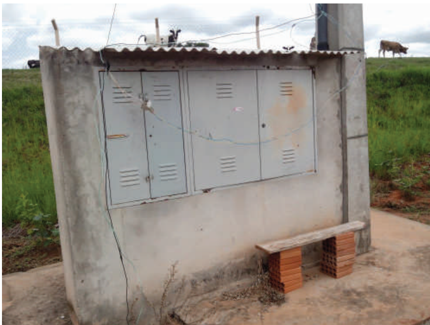
Foto 176: – Entrada de Energia do Quadro de Comando de Energia dos Motores das Bombas de Recalque Localização: Estação Elevatória de Esgoto Ribeirão Conchal
