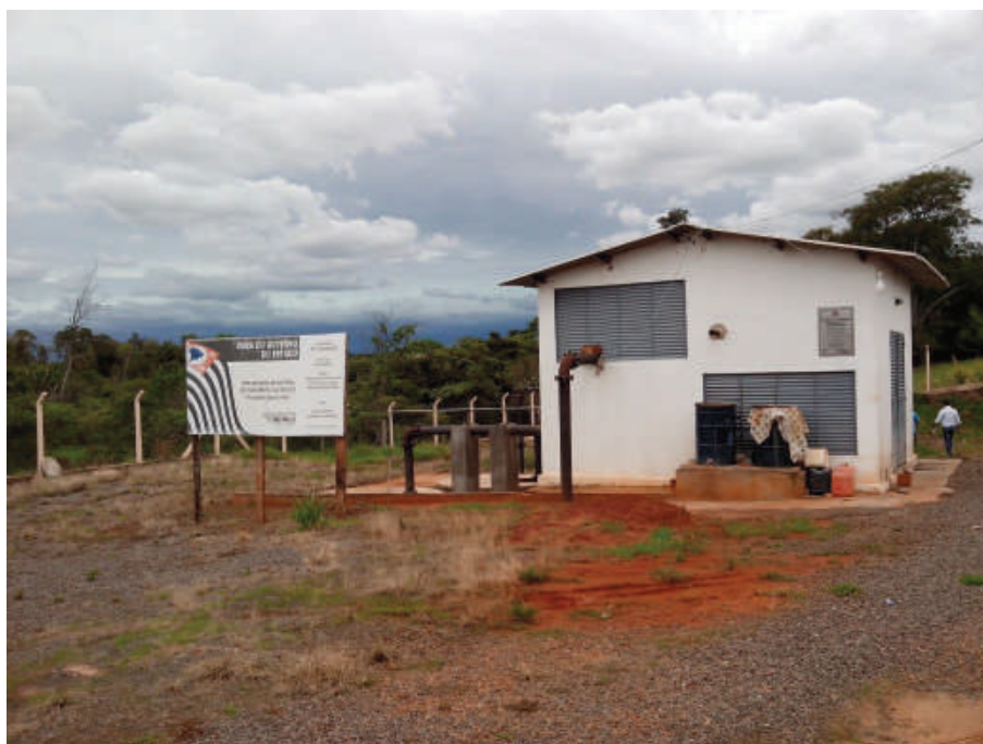
Foto 171: – Casa de Bombas de Recalque (Vista Frontal) Localização: Estação Elevatória de Esgoto Ribeirão Conchal
