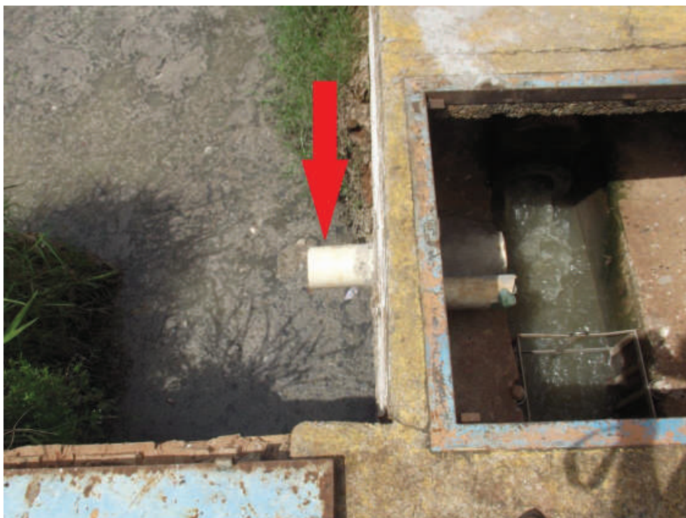
Foto 184: – Bomba de Recalque e Caixa de Entrada de Esgoto - Ao Lado ( Seta Vermelha ) onde foi feito uma saída para Extravasos Localidade: Estação Elevatória de Esgoto – Santa Rosa
