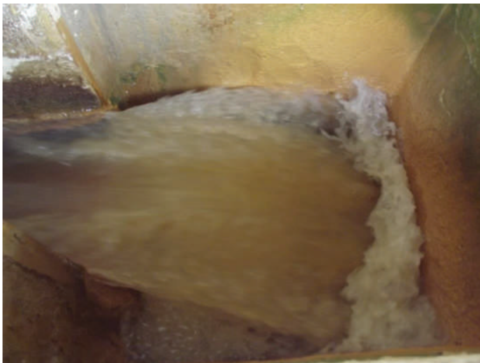
Foto 61: – Entrada da Água Bruta – Proveniente das Represas Santa Helena e São Lourenço Localização: ETA – Estação de Tratamento de Água
