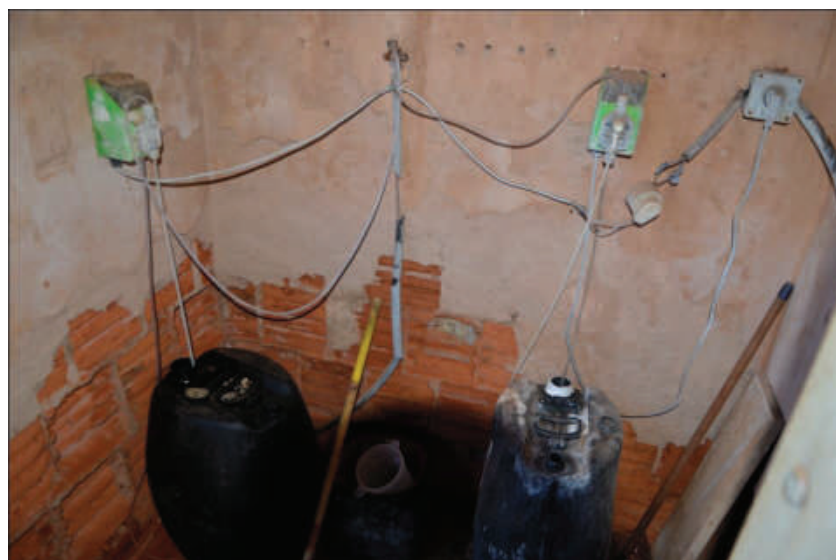
Foto 92: – Bombas Dosadoras e Produtos Químicos – P4 Localização: Jardim Santa Rosa
