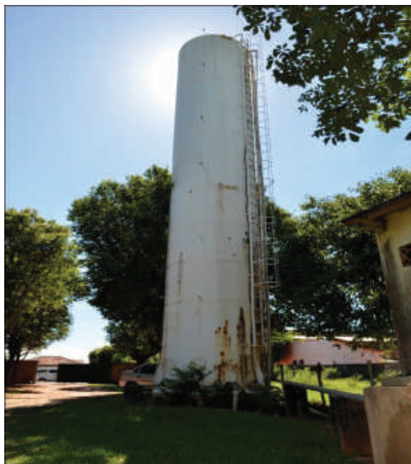
Foto 20: – Reservatório – Casa da Criança – Capacidade de 50m 3 Localização: Rua Japão, nº 2260
