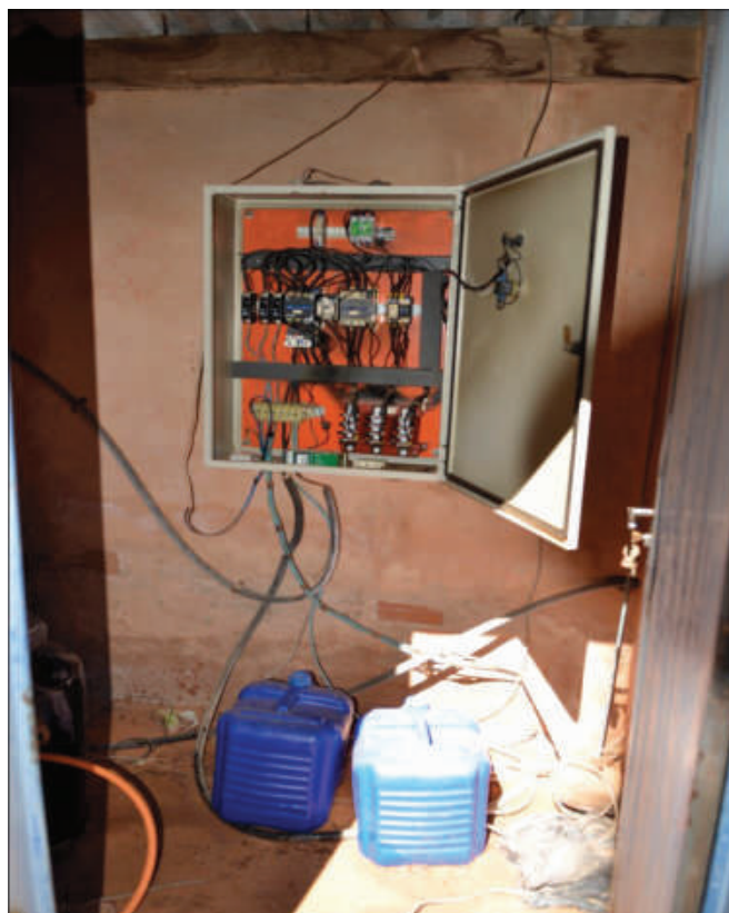
Foto 84: – Painel Elétrico – Poço P2 Localização: Casa da Criança.
