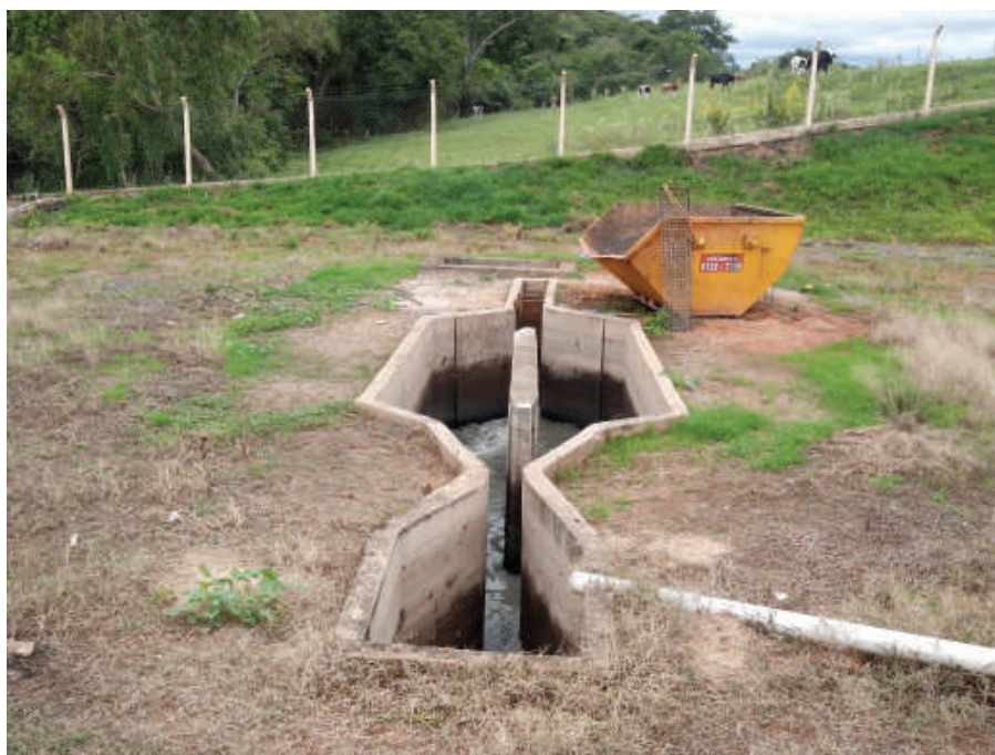
Foto 172: – Calha Parshall - Gradeamento Localização: Estação Elevatória de Esgoto Ribeirão Conchal
