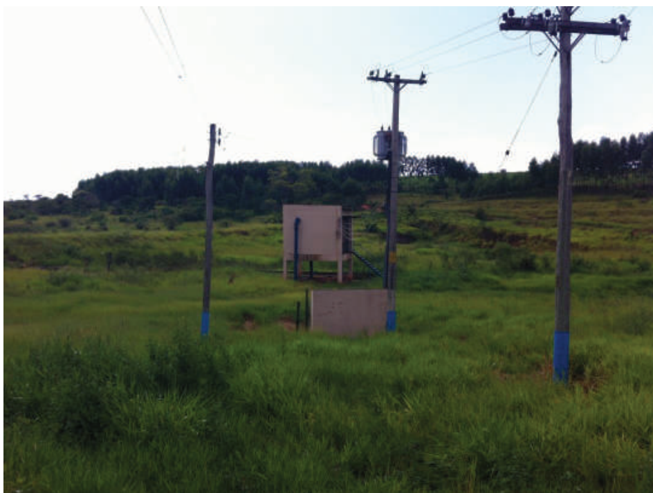
Foto 50: – Padrão e Casa de Máquinas da Captação da Água Bruta Localização: Barragem São Lourenço
