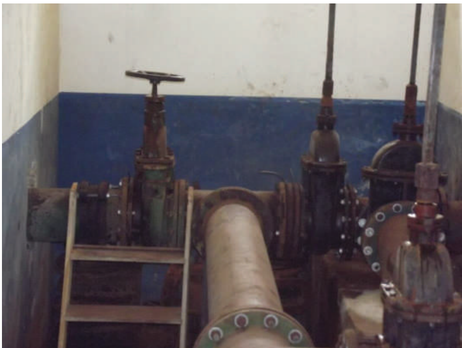
Foto 72: – Registros Para Manobras da Água já Tratada Localização: ETA – Estação de Tratamento de Água
