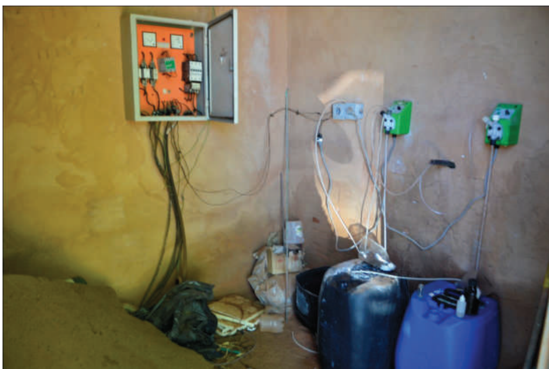
Foto 100: –Produtos Químicos, Bombas Dosadoras e Painel de Comando P12
