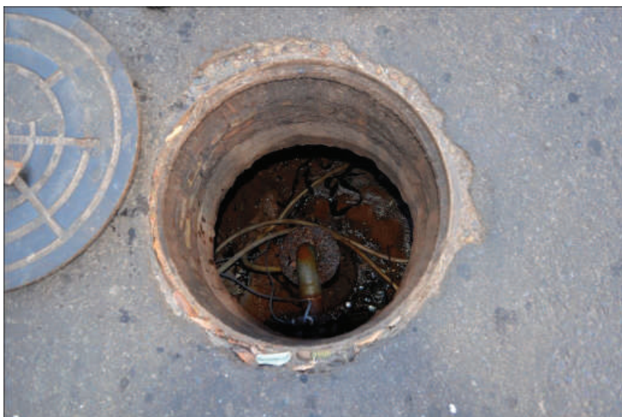
Foto 87: – PV – Poço de Visita onde esta Localizado o Poço P3 Localização: São Lourenço.
