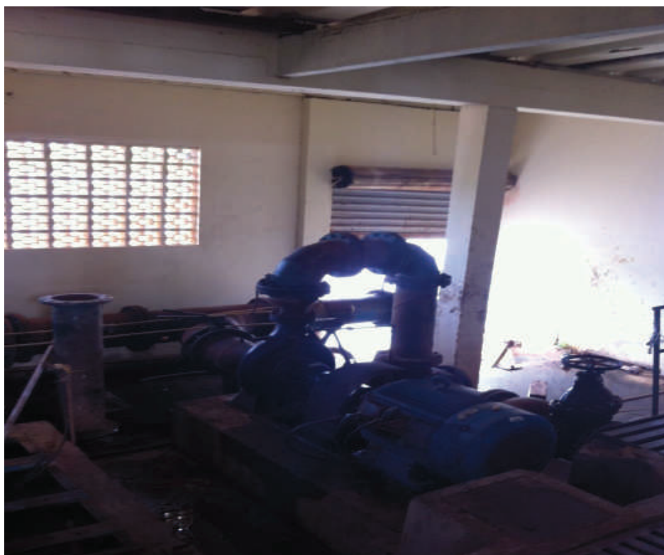
Foto 45: – Motor e Bomba da Captação da Água Bruta Localização: Barragem Santa Helena
