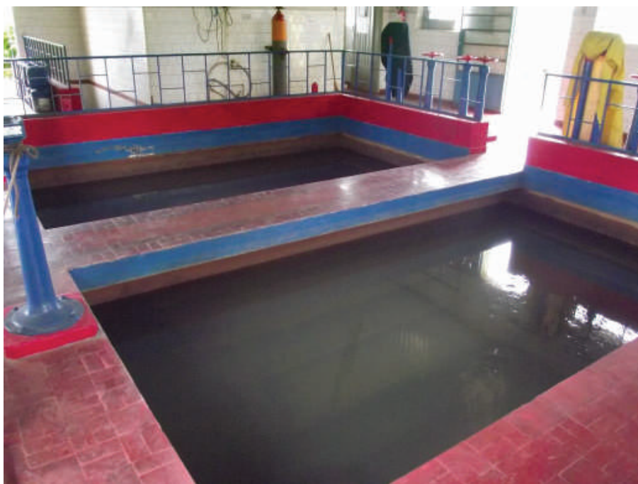
Foto 67: – Filtros do Tratamento e Registros ao Fundo Localização: ETA – Estação de Tratamento de Água
