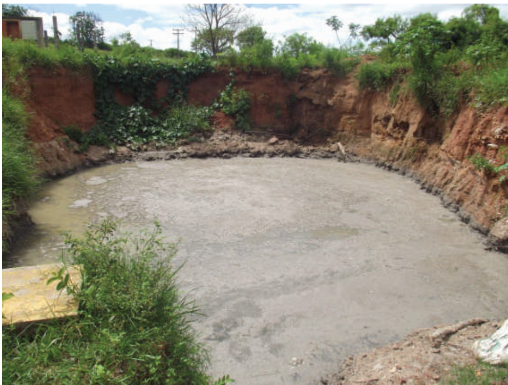
Foto 185: – Vala Executada pelo SAAEM para Conter os Constantes Extravasos de Esgotos Localidade: Estação Elevatória de Esgoto – Santa Rosa
