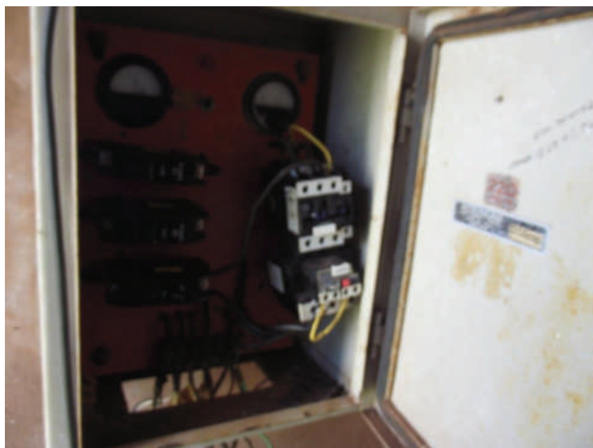
Foto 136: – Painel de Comando – P1 Localização: Bairro Terceira Aliança
