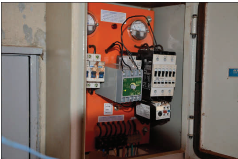
Foto 121: – Painel de Comando – Poço P18 Localização: Vale do Sol
