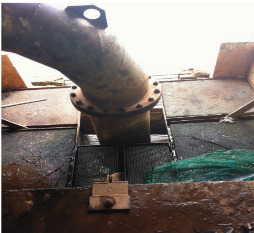
Foto 43: – Local da Captação da Água Bruta Localização: Barragem Santa Helena
