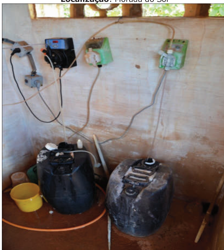
Foto 110: – Bombas Dosadoras e Produtos Químicos – Poço P10 Localização: Morada do Sol
