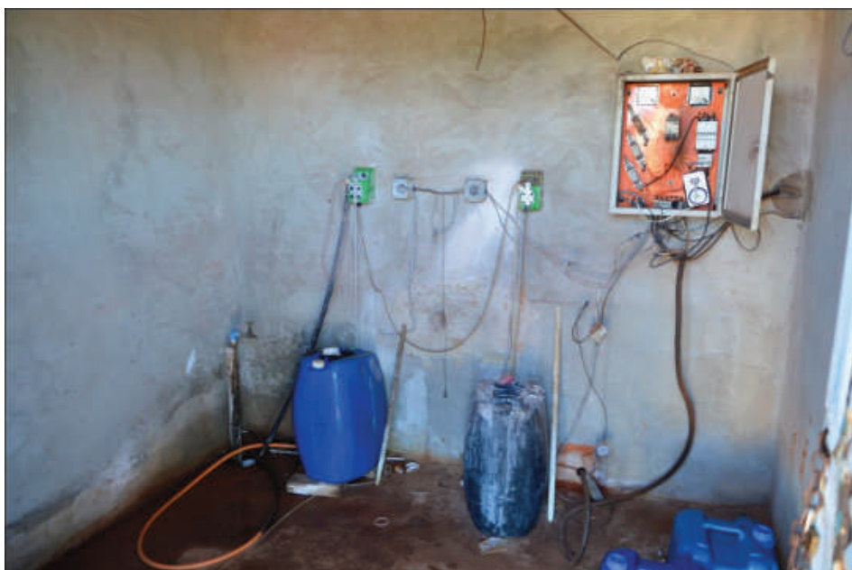
Foto 119: – Bombas Dosadoras e Painel de Comando – Poço P20 Localização: CDHU / Sonho Meu
