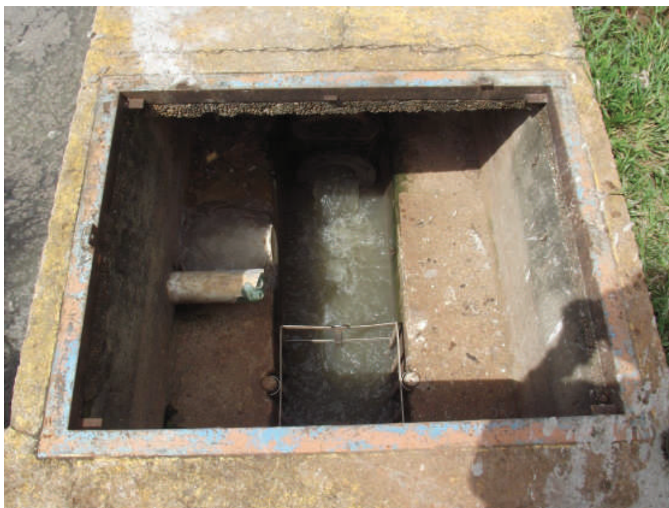
Foto 183: – Local da Bomba de Recalque (Bomba Submersa) Localidade: Estação Elevatória de Esgoto – Santa Rosa
