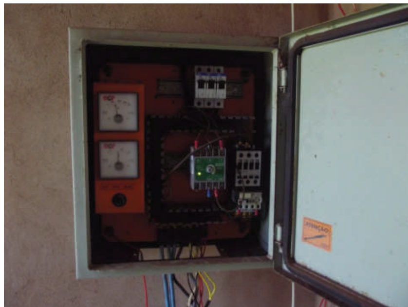
Foto 132: – Painel Elétrico – P17 Localização: Bairro Segunda Aliança / Igreja
