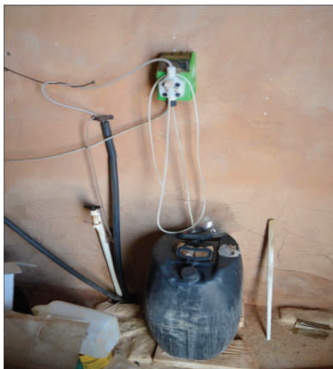
Foto 115: – Produtos Químicos e Bombas Dosadoras – Poço P13 Localização: – Jardim Sampaio
