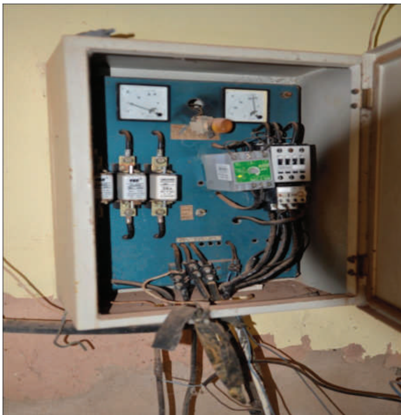
Foto 124: – Painel De Comando Localização: Bairro Amandaba
