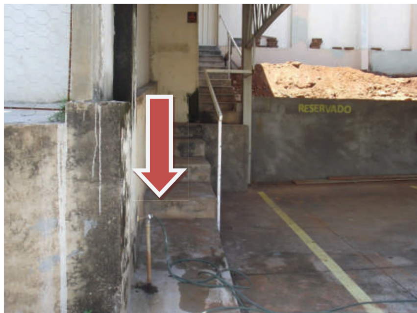
Foto 13: - Fotos Cavalete Sem Hidrômetro
