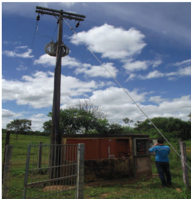
Foto 180: – Padrão e Entrada de Energia Localidade: Estação Elevatória de Esgoto – Santa Rosa
