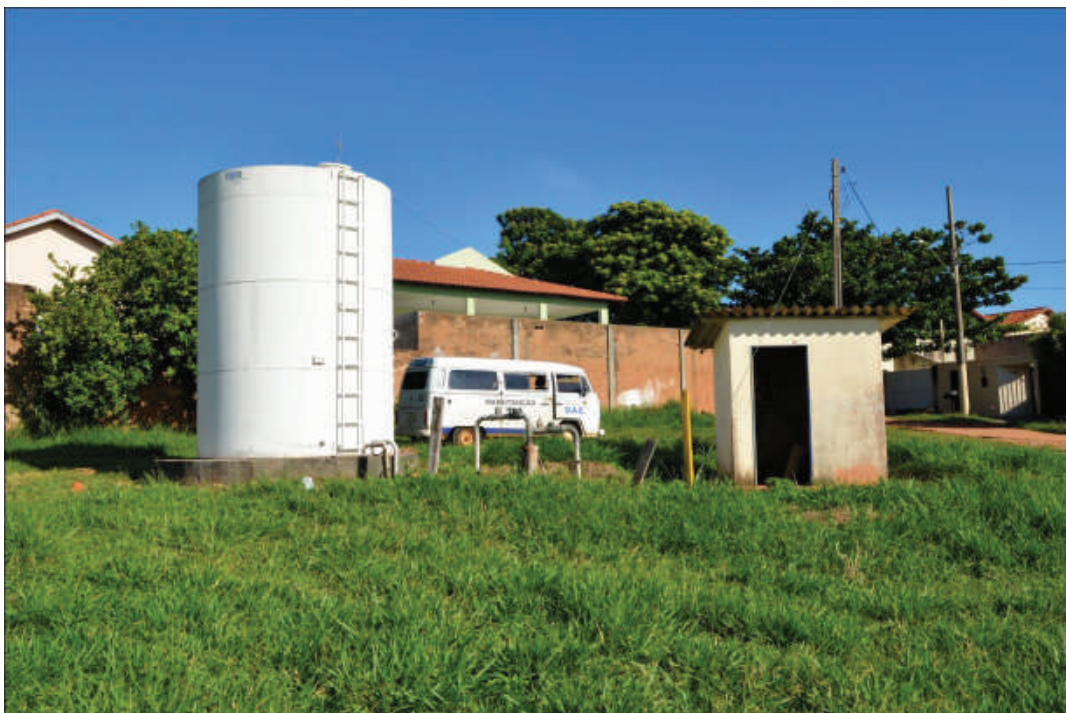
Foto 113: – Reservatório, Local de Armazenamento dos Produtos Químicos e Entrada do Poço P13 Localização: – Jardim Sampaio
