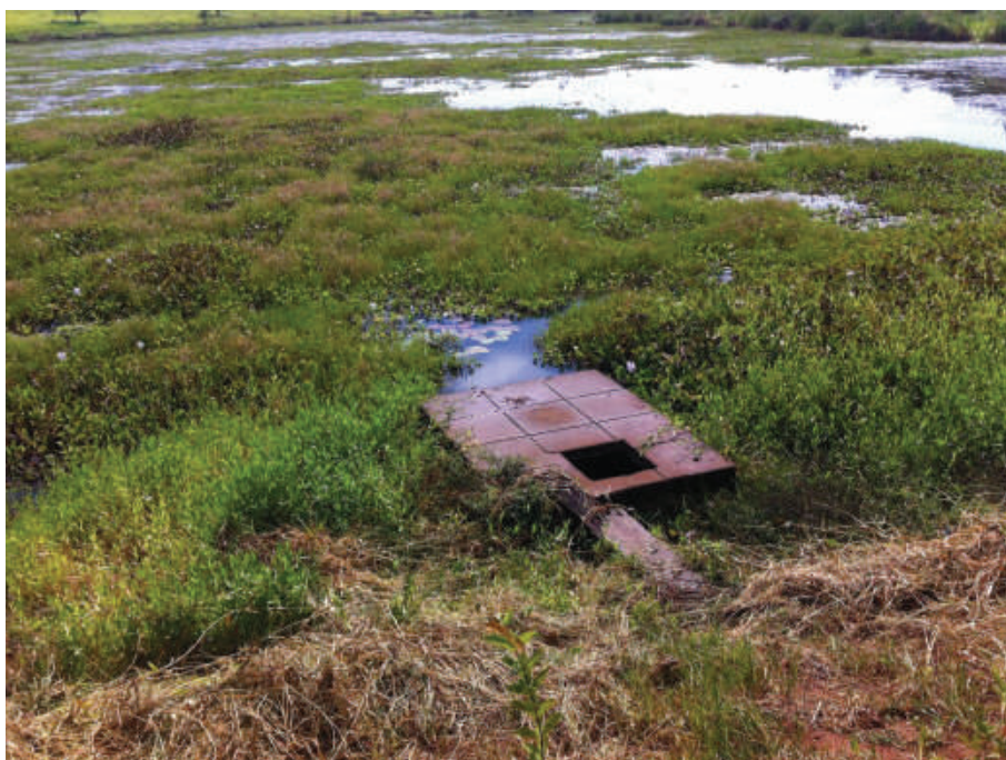
Foto 56: – Local de Entrada da Captação da Água Bruta Localização: Barragem São Lourenço
