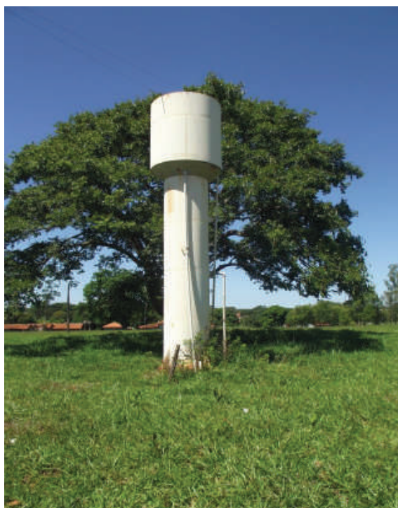
Foto 34: – Reservatório do Bairro Segunda Aliança / Alto Alegre - Capacidade: 10m 3
