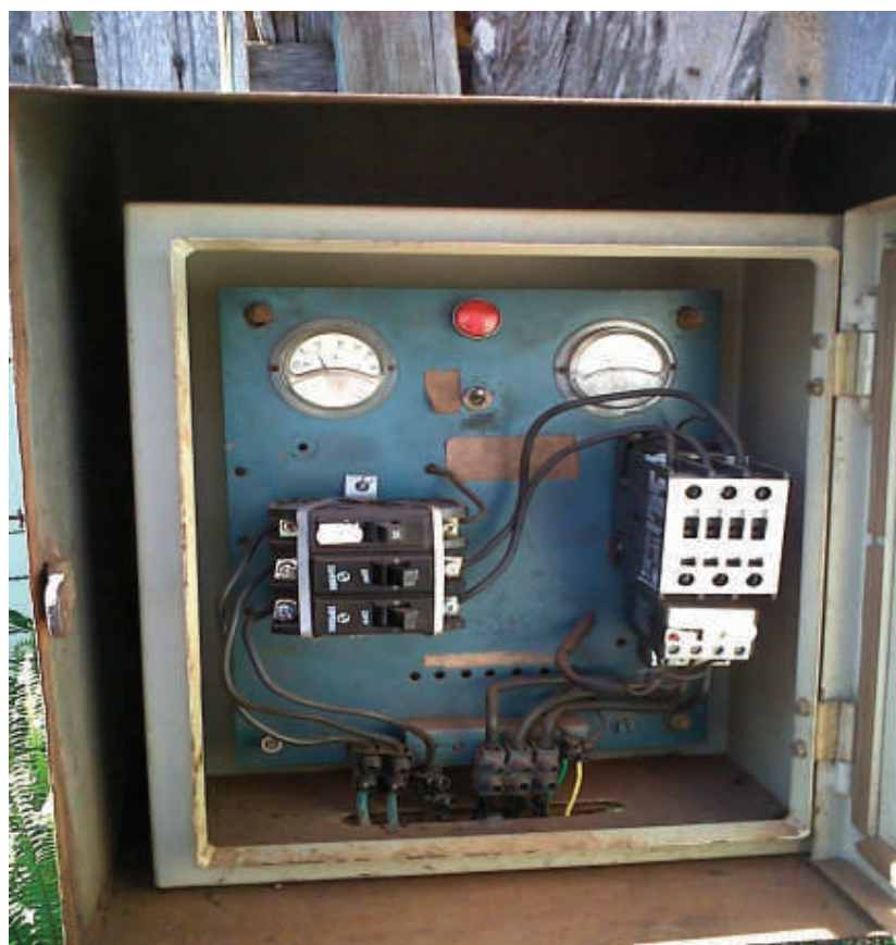
Foto 131: – Painel Elétrico - P1 Localização: Bairro Segunda Aliança / Alto Alegre
