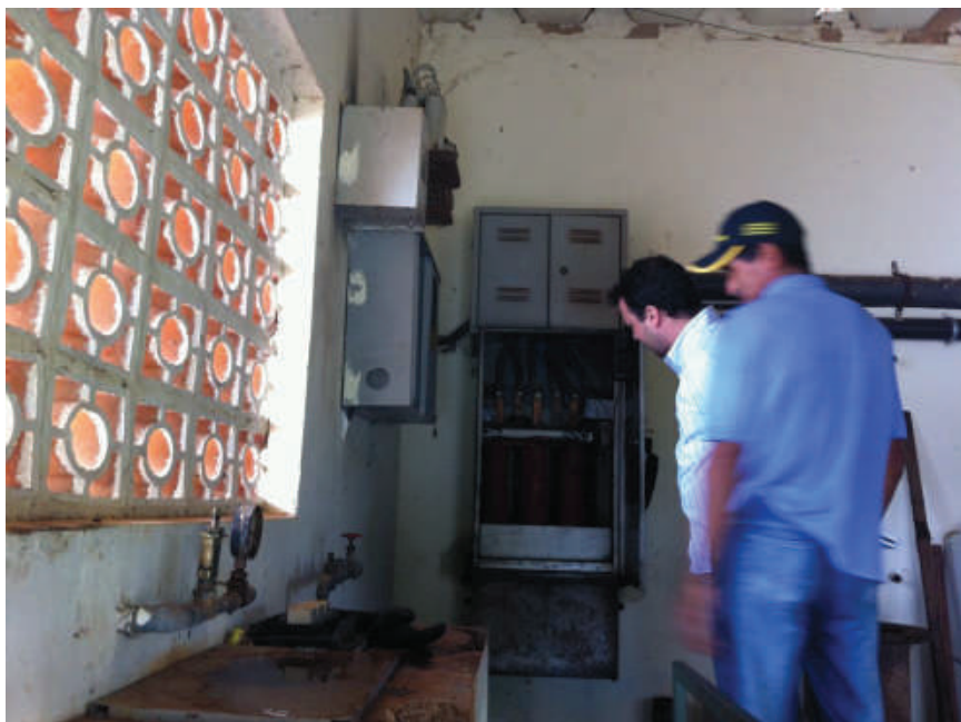
Foto 47: – Painel Elétrico dos Motores da Captação da Água Bruta Localização: Barragem Santa Helena
