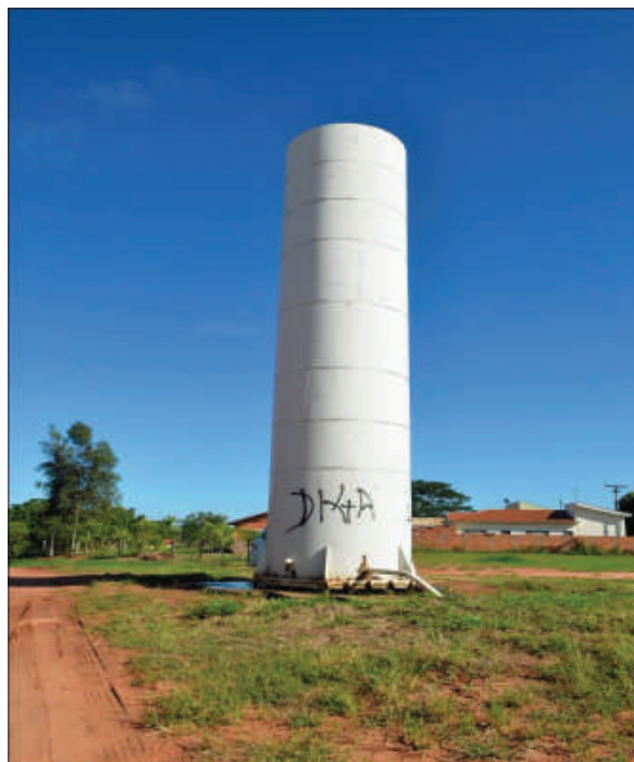
Foto 24: – Reservatório Bela Vista – Capacidade 50m 3 Localização: Rua Profeta Gentileza, nº 214
