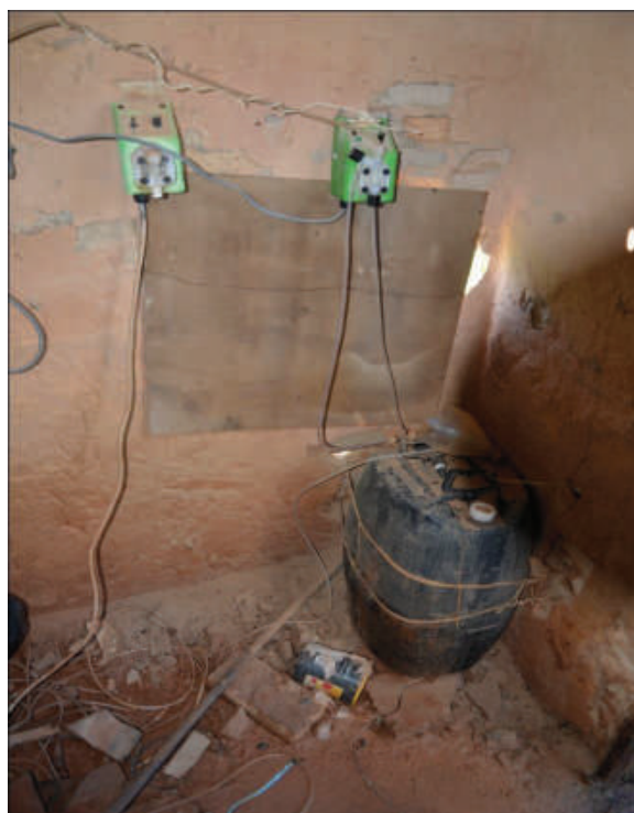
Foto 82: – Produtos Químicos e Bombas Dosadoras (Cloro e Flúor) – Poço P1 Localização: Jardim Aeroporto.
