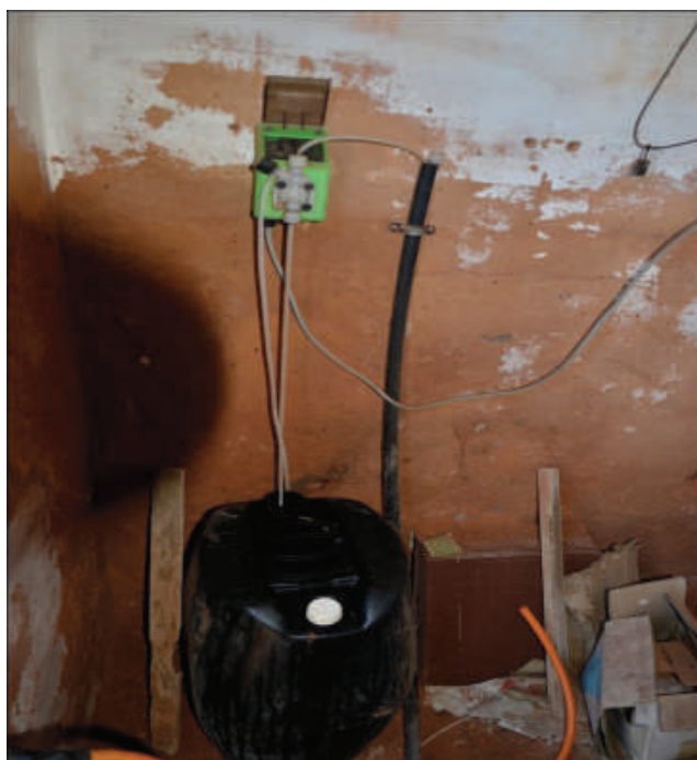
Foto 103: – Produtos Químicos, Bombas Dosadoras e Painel de Comando P8 Localização: – São Lourenço de Fátima II
