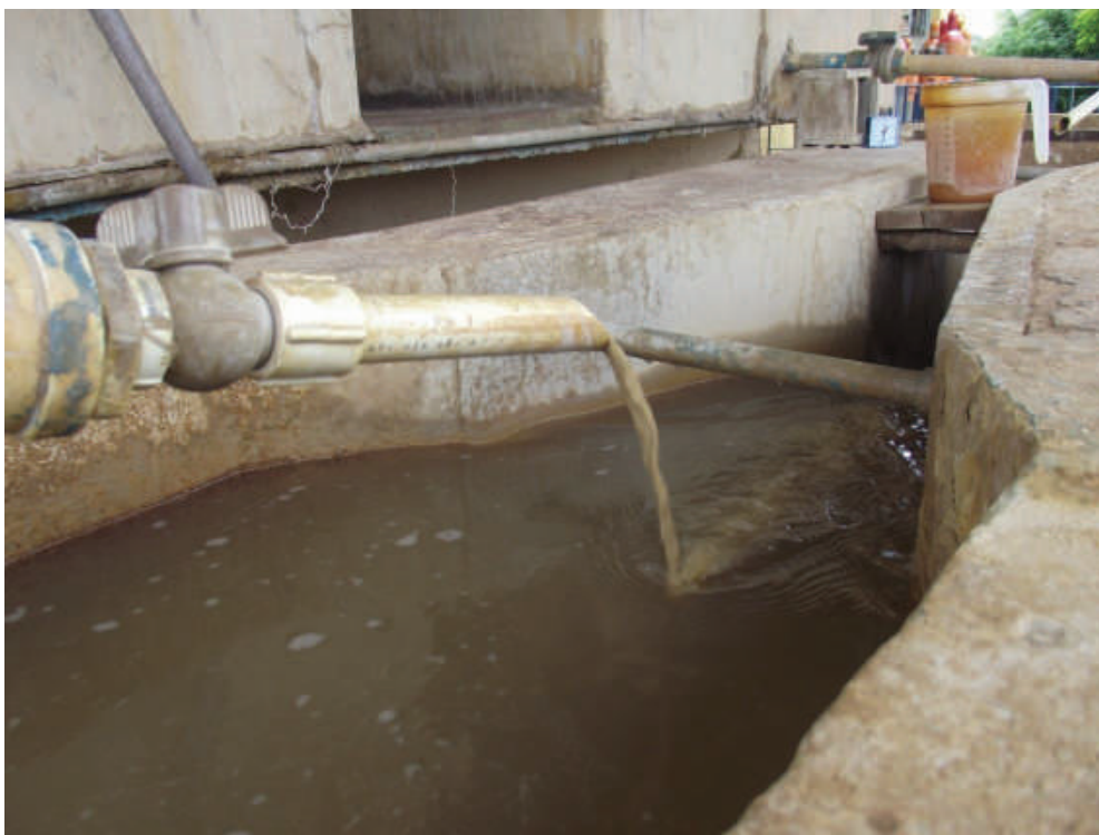
Foto 62: – Adição de Sulfato de Alumínio Ferroso – Água Bruta Localização: ETA – Estação de Tratamento de Água
