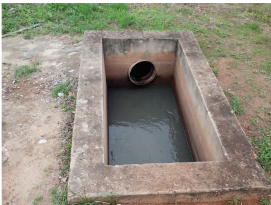
Foto 174: – Caixa de Areia Localização: Estação Elevatória de Esgoto Ribeirão Conchal
