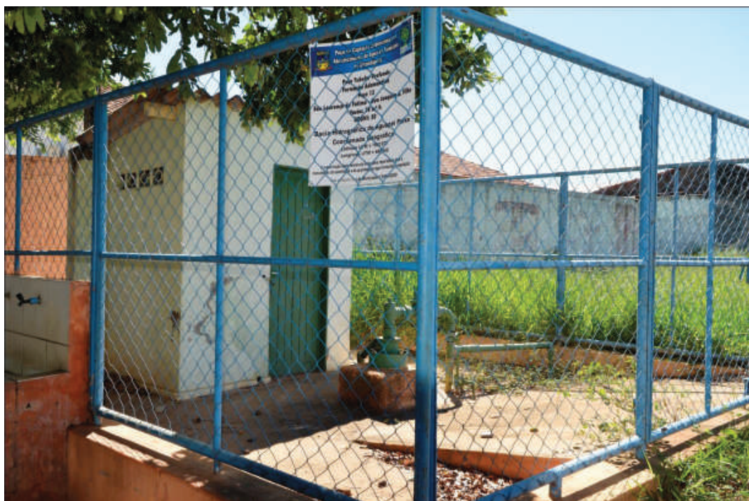
Foto 101: –Produtos Químicos, Bombas Dosadoras e Painel de Comando P8 Localização: – São Lourenço de Fátima II
