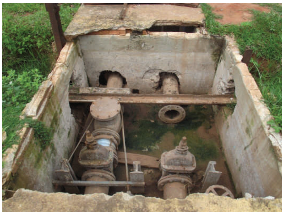
Foto 182: – Registros das Bombas de Recalque Localidade: Estação Elevatória de Esgoto – Santa Rosa
