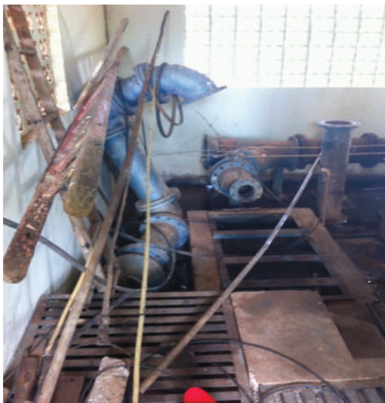
Foto 48: – Casa de Máquinas da Captação da Água Bruta Localização: Barragem Santa Helena
