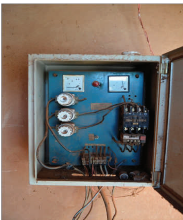
Foto 94: – Painel de Comando do Poço P5 Localização: Conj. Habitacional Agostinho Franco
