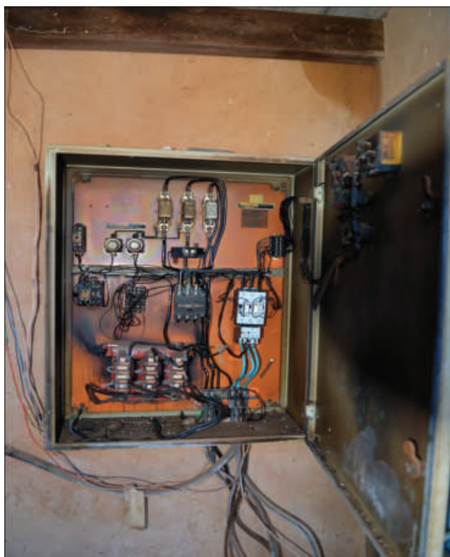
Foto 91: – Painel de Comando do Poço P4 Localização: Jardim Santa Rosa
