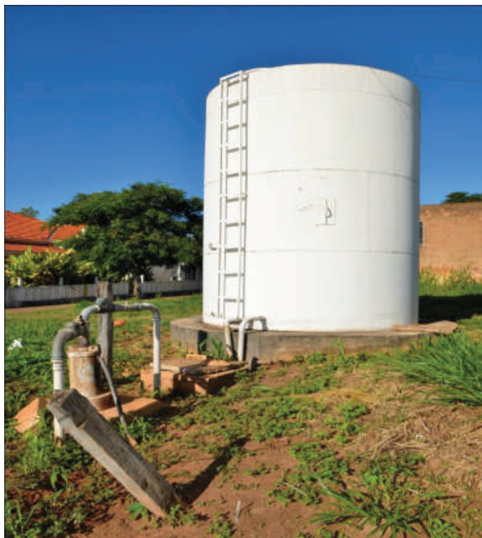
Foto 29: – Reservatórios Jardim Sampaio Localização: Rua Ana Luiza da Conceição, nº 111
