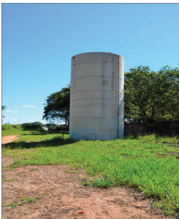
Foto 26: –Reservatórios Colina Verde – Capacidade 76m 3 Localização: Rua Cecília Gonçalves Tosta, nº 363
