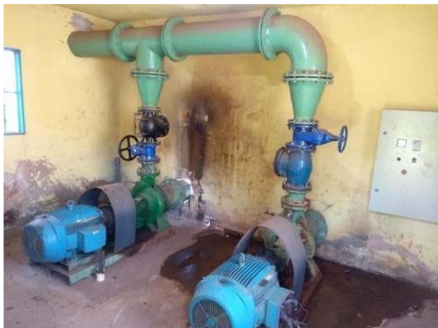
Figura 52. Vista geral dos conjuntos motor-bombas
