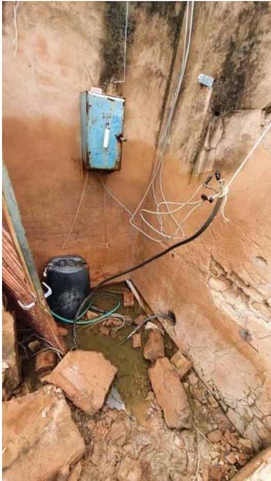
Figura 71. Vista interna da casa de química do Poço P01
