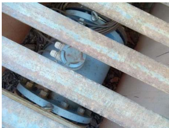
Figura 42. Vista do visor do macromedidor de vazão
