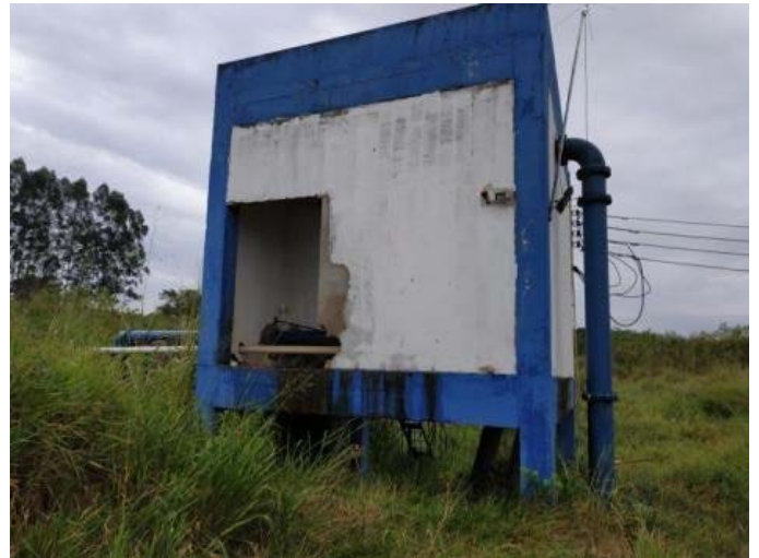
Figura 16. Vista geral da casa de bombas da Cap. São Lourenço
