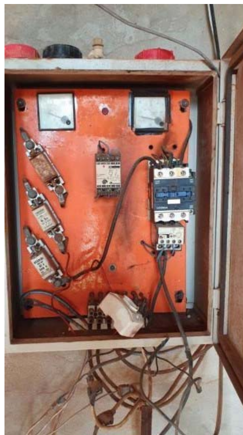
Figura 119. Vista interna do painel elétrico
