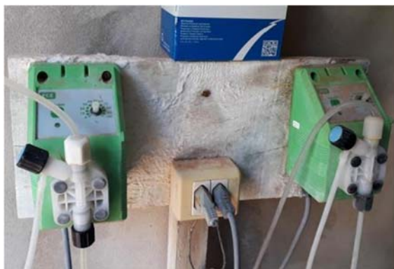
Figura 103. Vista das bombas dosadoras da casa de química
