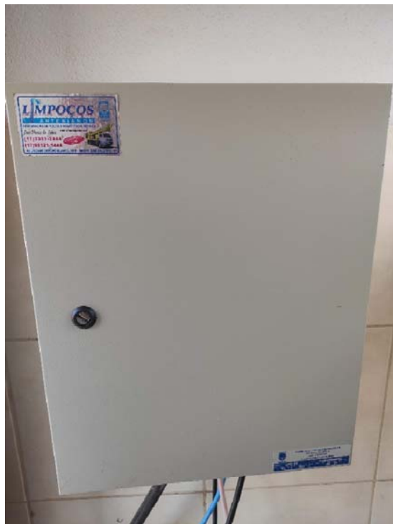
Figura 189. Vista externa do painel elétrico
