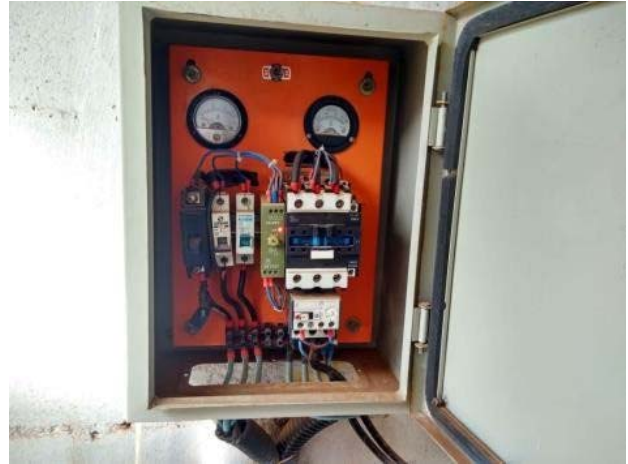
Figura 128. Vista interna do painel elétrico
