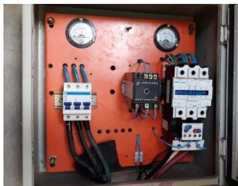
Figura 92. Vista interna do painel Elétrico
