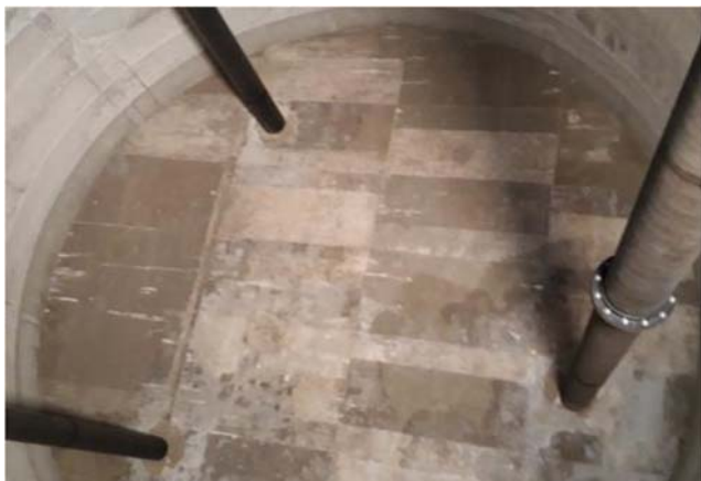
Figura 64. Vista geral das tubulações do REL 02
