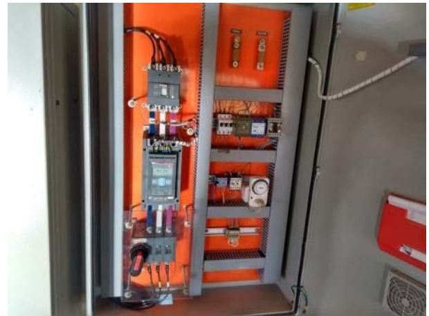
Figura 72. Vista interna do painel elétrico do P01 que fica junto a Captação Santa Helena
