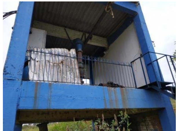
Figura 20. Vista geral da casa de bombas da Cap. São Lourenço
