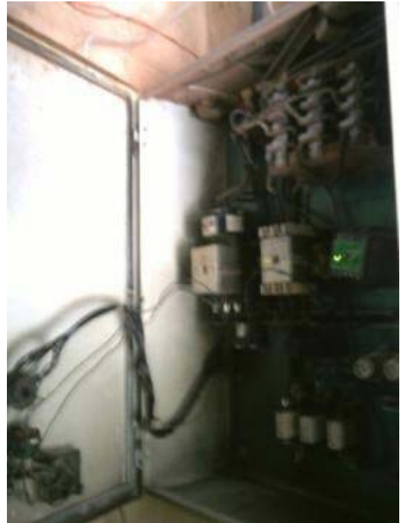
Figura 172. Vista interna do painel elétrico
