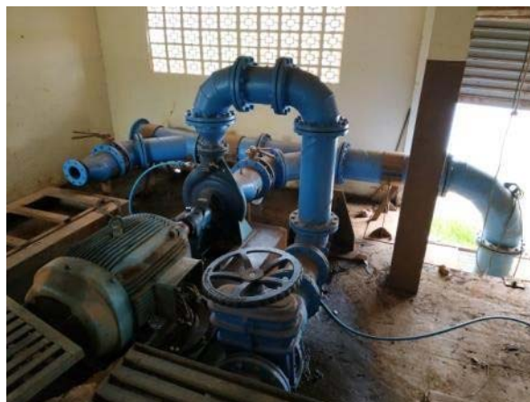
Figura 33. Vista geral do barrilete da casa de bombas
