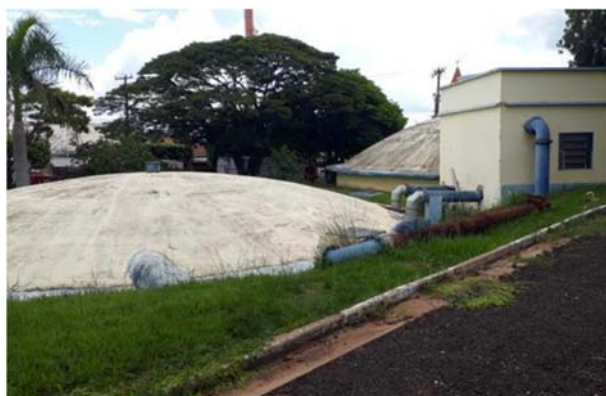
Figura 57. Vista geral com a casa de bombas, RSE 01 e RSE 02
