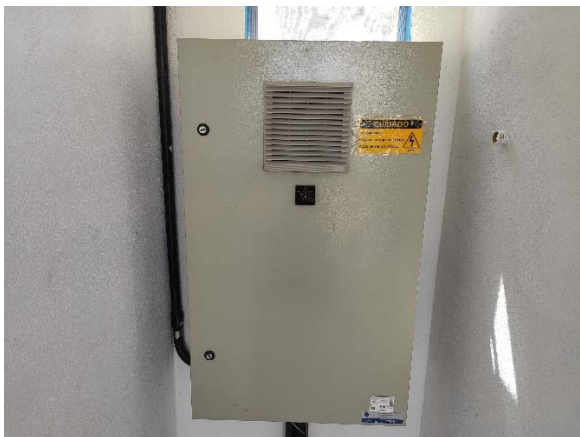
Figura 178. Vista externa do painel elétrico
