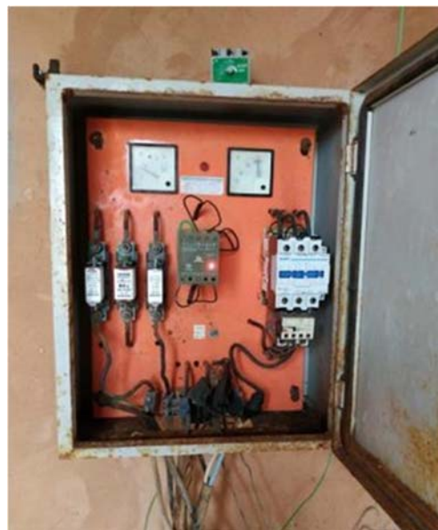
Figura 154. Vista interna do painel elétrico
