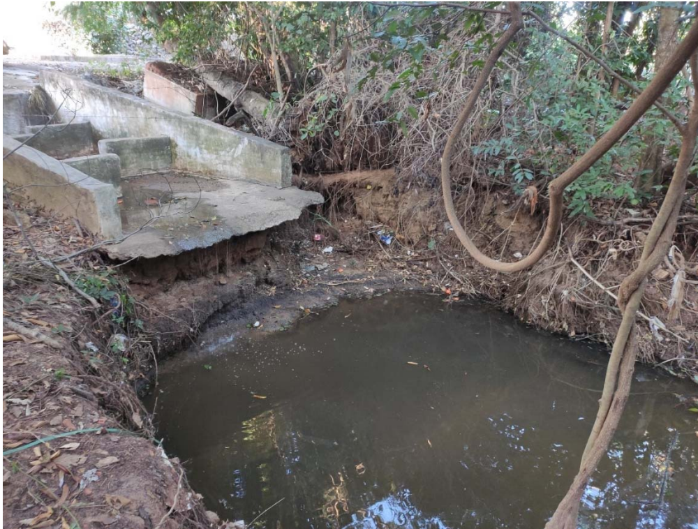
Figura 230: Ponto de erosão na Rua Maestro Henrique Pavesi (Dissipador de energia danificado)
