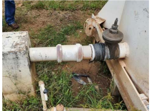
Figura 214. Vista geral da tubulação de saída Ø100mm do REL-07
