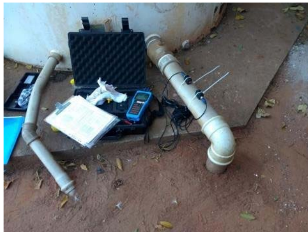
Figura 125. Vista das tubulações de entrada e saída do RAP -07
