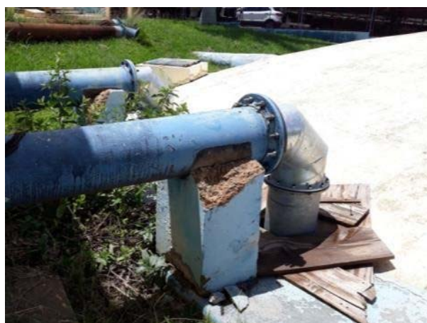
Figura 59. Vista geral das tubulações de sucção
