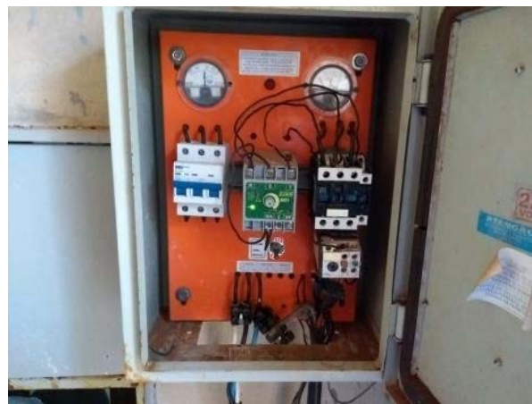
Figura 121. Vista interna do painel elétrico
