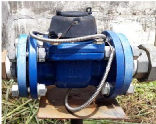
Figura 102. Vista do macromedidor de vazão do P06
