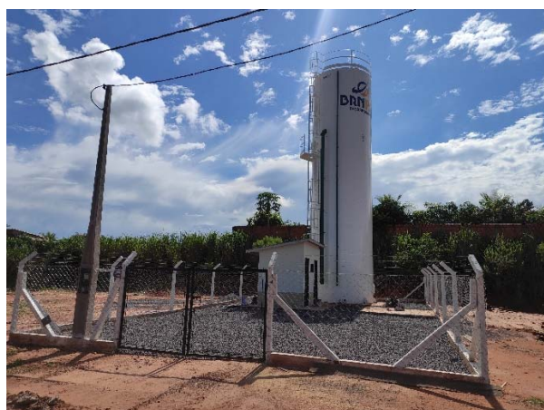
Figura 183. Vista Geral P27, casa de dosagem e RAP-16
