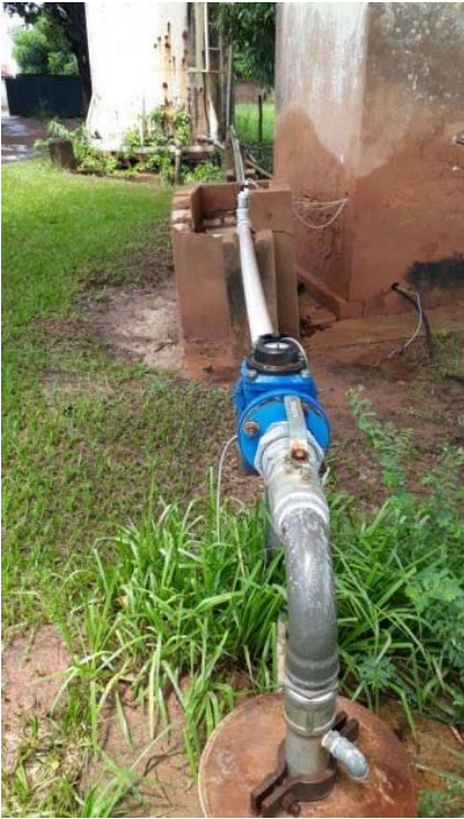
Figura 75. Vista da tubulação de recalque do poço P02
