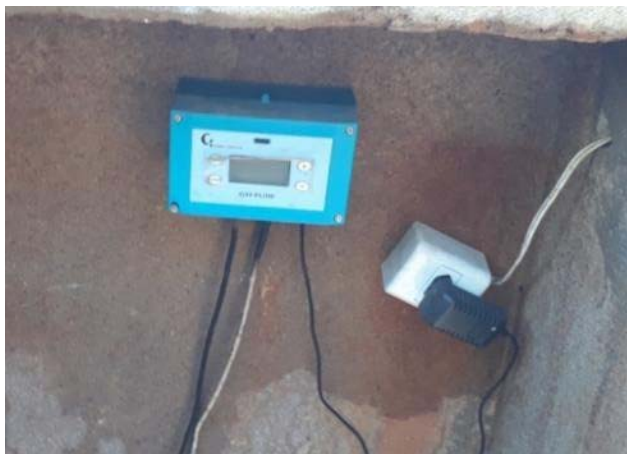
Figura 60. Vista do macromedidor da saída do RSE 01 que não funciona
