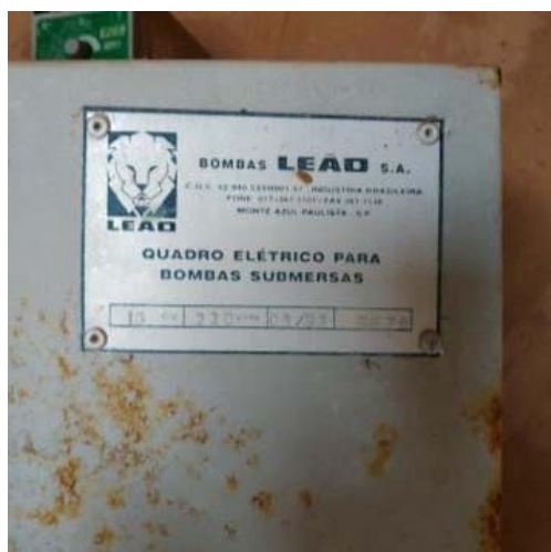
Figura 155. Vista geral da placa de identificação do painel elétrico
