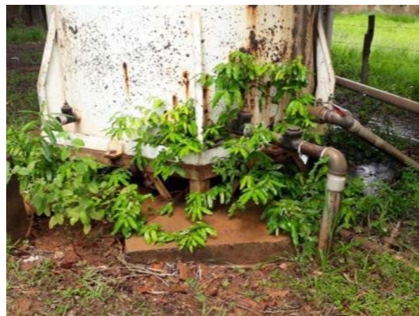
Figura 81. Vista das tubulações de saída do RAP-01
