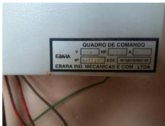
Figura 136. Vista da placa de identificação do painel
