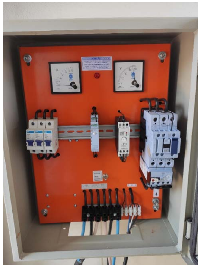
Figura 190. Vista interna do painel elétrico
