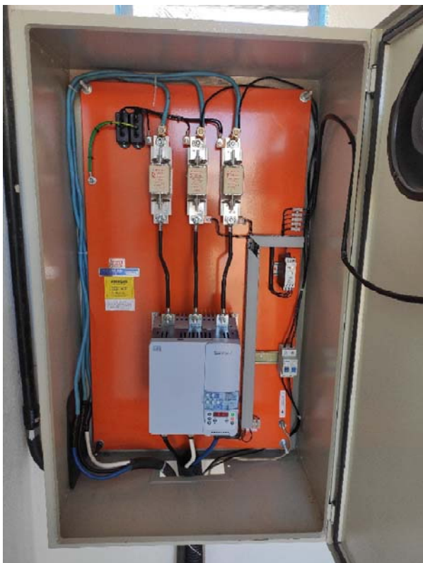
Figura 179. Vista interna do painel elétrico
