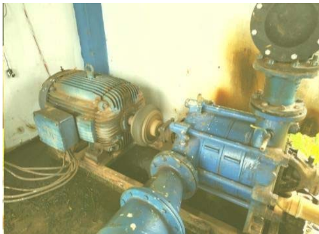
Figura 24. Vista geral do conjunto motor-bomba da Cap. São Lourenço
