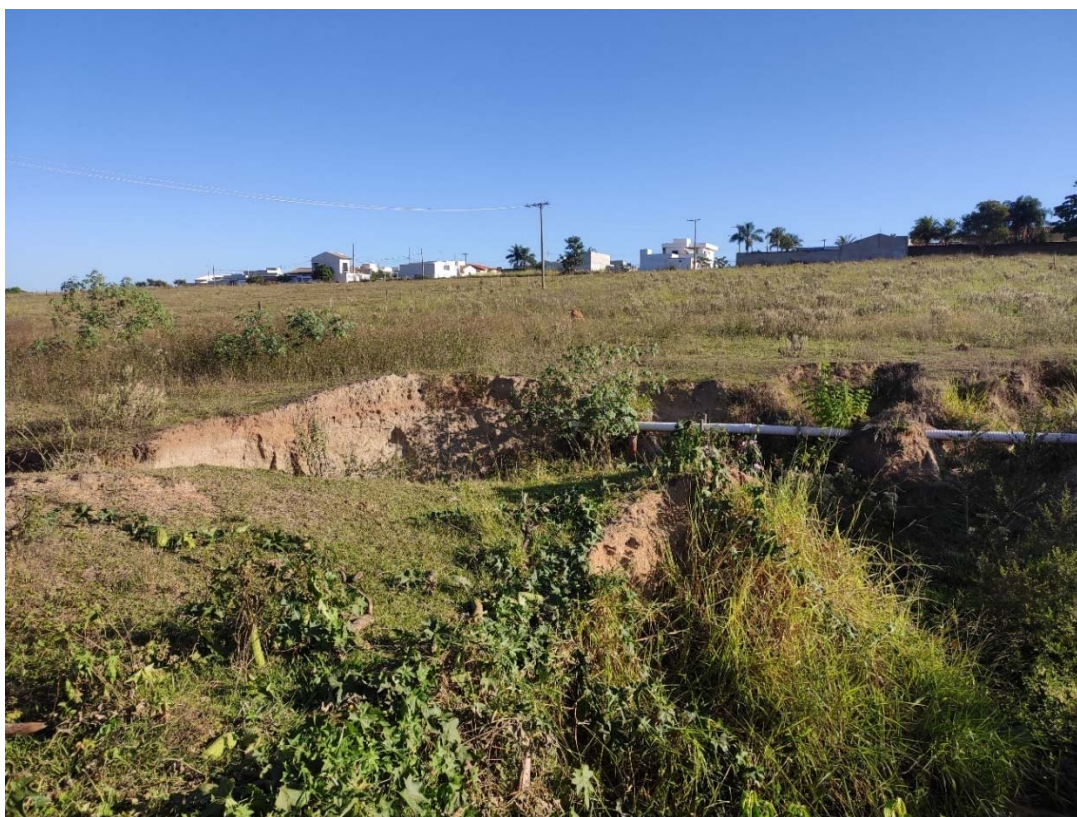
Figura 227: Ponto de erosão com tubulação exposta.
