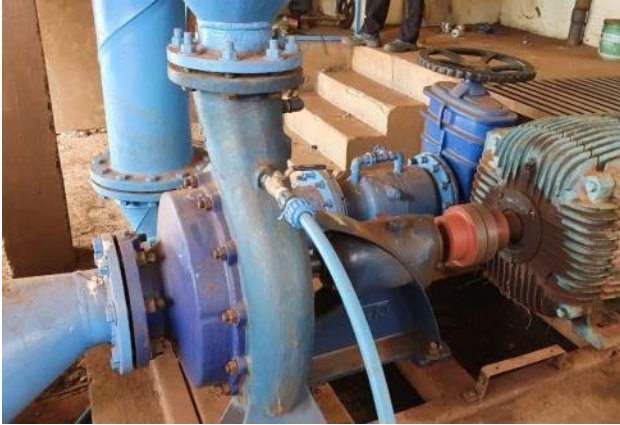
Figura 36. Vista geral do conjunto motor-bomba
