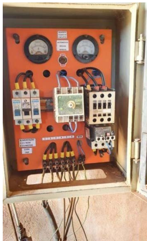
Figura 210. Vista interna do painel elétrico
