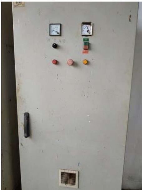
Figura 27. Vista externa do painel elétrico dos conjuntos motor-bombas
