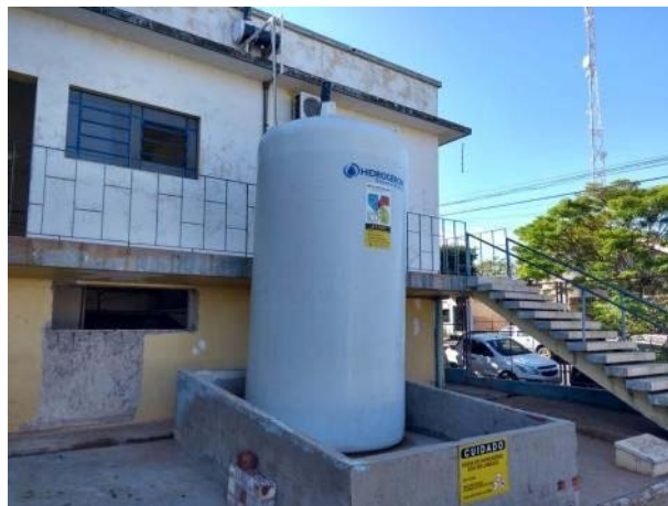
Figura 50. Vista geral do tanque de dosagem de Hipoclorito de sódio
