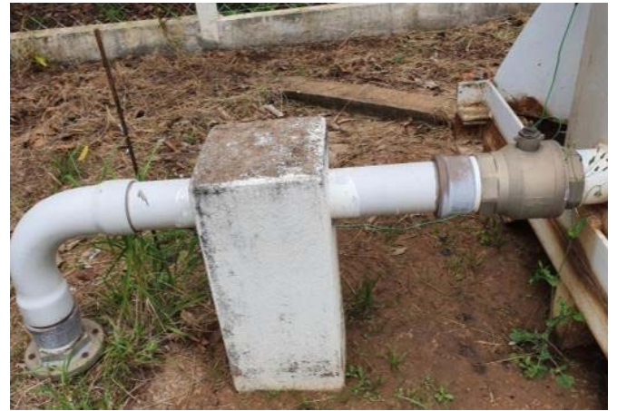
Figura 217. Vista geral da tubulação de saída Ø50mm do REL-07
