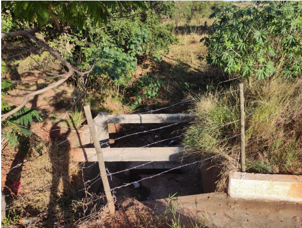
Figura 232: Ponto de erosão na Rua Antônio Nozela (estrutura danificada)
