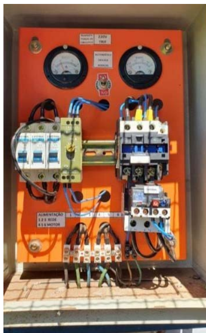
Figura 204. Vista interna do painel elétrico
