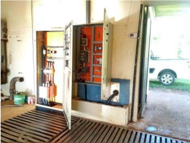
Figura 44. Vista interna dos painéis da captação Santa Helena
