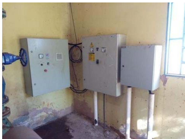
Figura 51. Vista externa dos painéis elétricos
