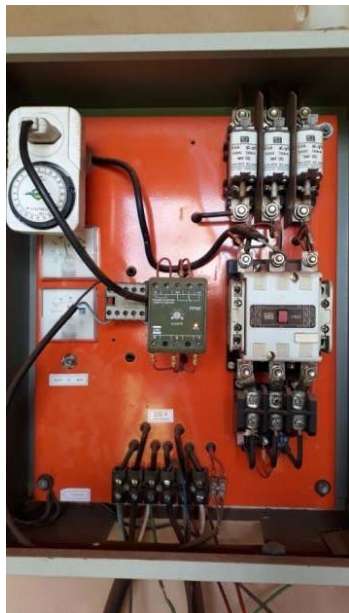
Figura 135. Vista interna do painel elétrico
