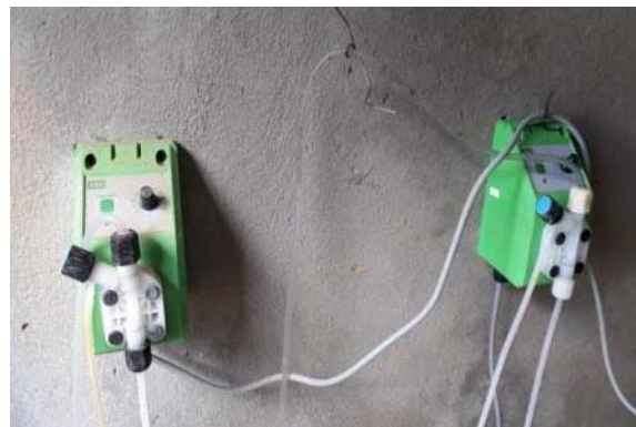
Figura 95. Vista das bombas dosadoras da casa de química
