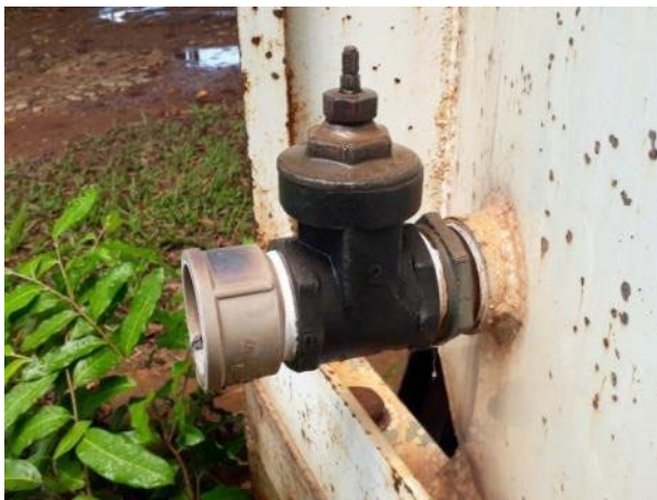
Figura 82. Vista da tubulação de descarga
