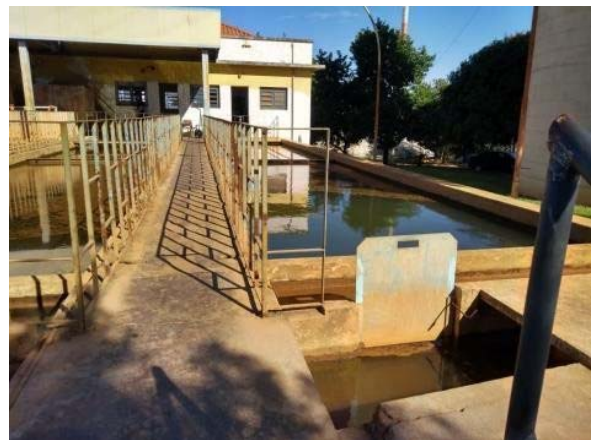
Figura 47. Vista geral da ETA mostrando os decantadores
