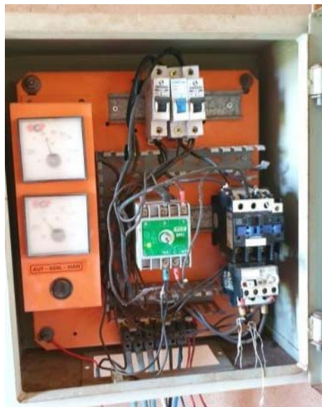
Figura 199. Vista interna do painel elétrico
