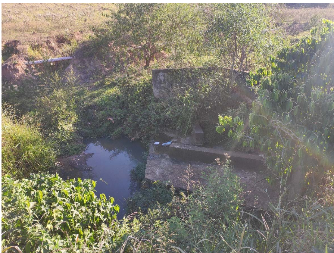
Figura 226: Ponto de erosão no prolongamento da Av. Ipê, estrutura danificada.
