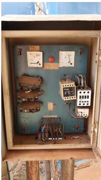
Figura 195. Vista interna do painel elétrico
