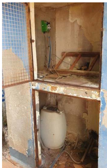
Figura 196. Vista interna do painel elétrico do P18.
