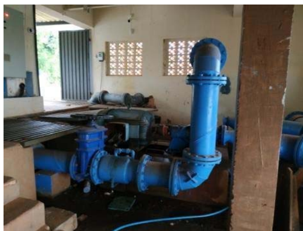
Figura 35. Vista geral do barrilete da casa de bombas
