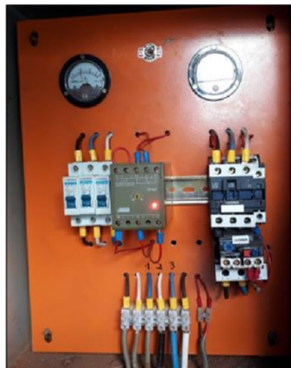
Figura 87. Vista interna do painel
