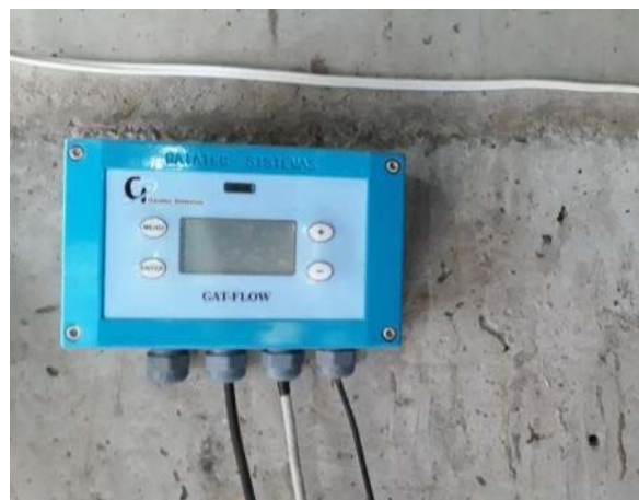
Figura 63. Vista geral do macromedidor do REL 01
