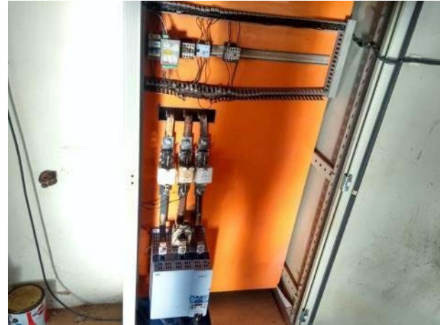
Figura 45. Vista interna do painel elétrico da captação Santa Helena com soft-start
