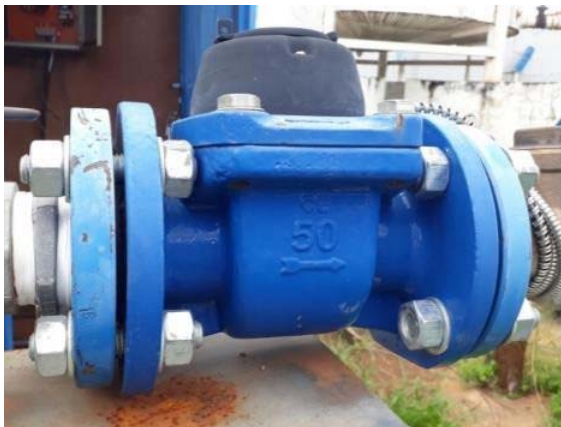
Figura 86. Vista do macromedidor instalado no recalque do P03
