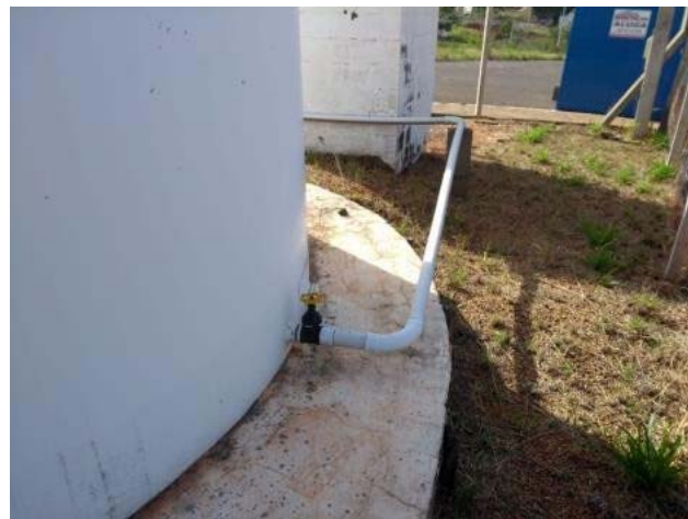
Figura 131. Vista da tubulação de saída para abastecimento
