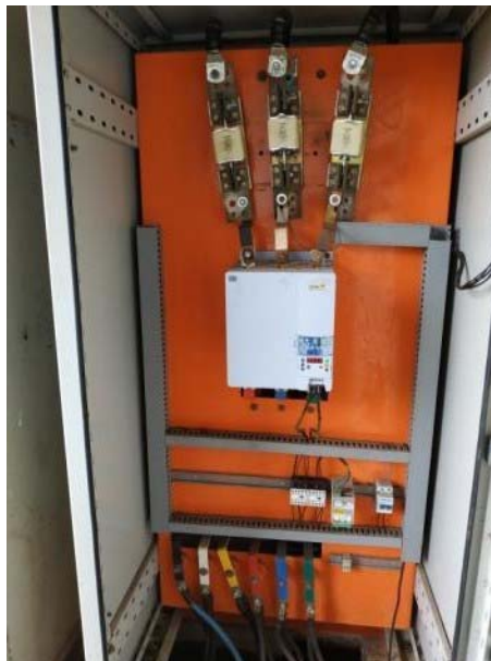
Figura 28. Vista interna do painel elétrico dos conjuntos motor-bombas
