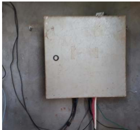
Figura 90. Vista externa do painel elétrico
