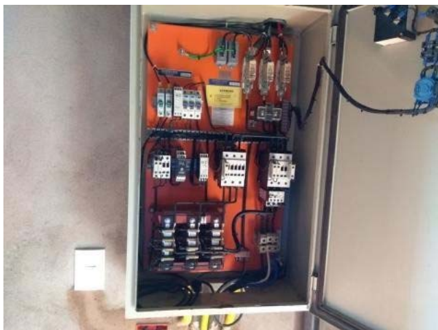
Figura 150. Vista interna do painel elétrico
