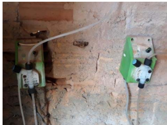
Figura 77. Vista das bombas dosadoras da casa de química
