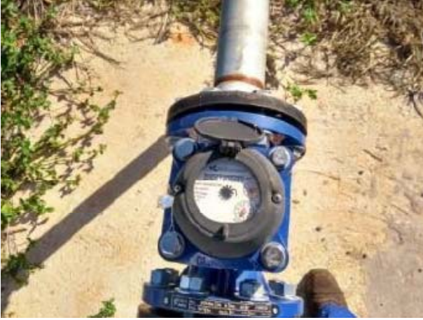
Figura 147. Vista do macromedidor
