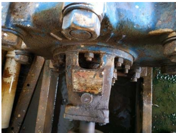
Figura 23. Vista geral da placa de identificação do conjunto Motor-bomba
