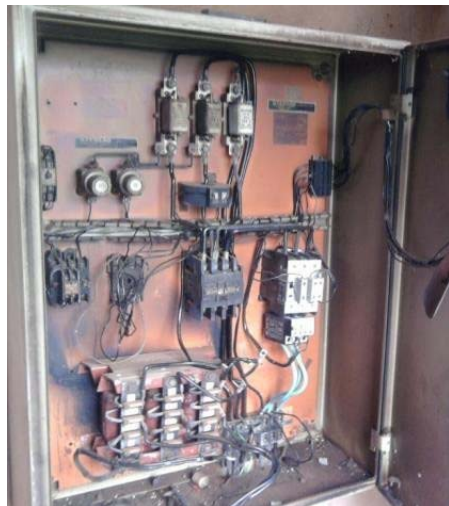
Figura 166. Vista interna do painel elétrico
