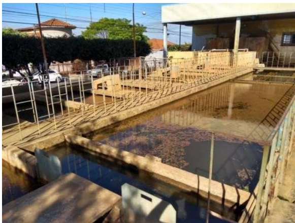
Figura 46. Vista geral dos flocladores e decantadores
