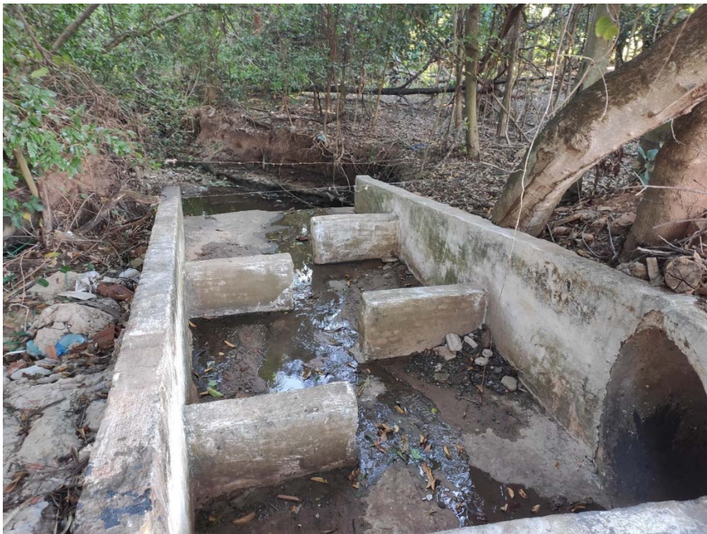
Figura 229: Ponto de erosão na Rua Maestro Henrique Pavesi (Dissipador de energia)
