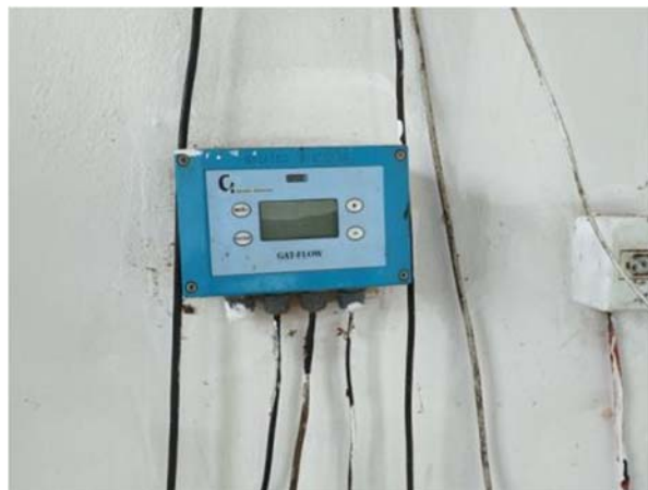
Figura 25. Vista do visor do macromedidor da Cap. São Lourenço
