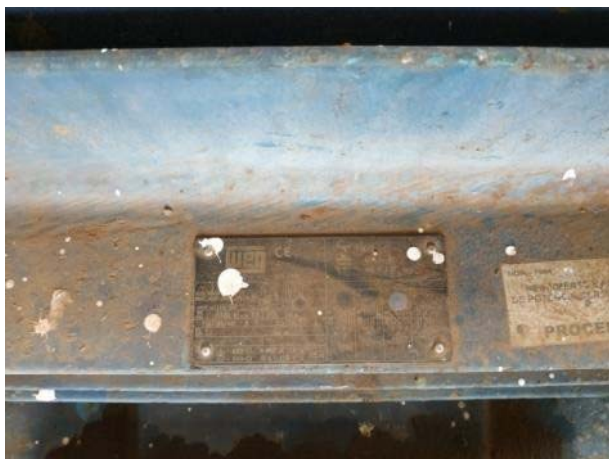
Figura 26. Vista da placa de identificação do motor das bombas
