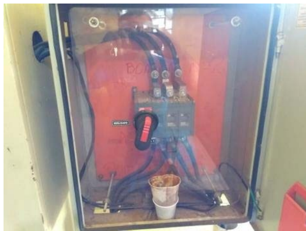
Figura 54. Vista interna do painel elétrico4
