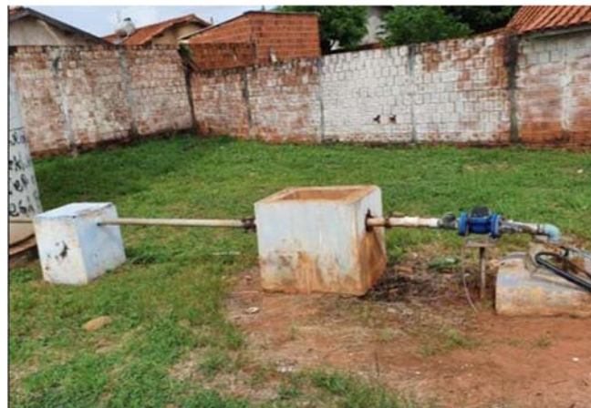
Figura 115. Vista geral do poço P08 com o macromedidor existente
