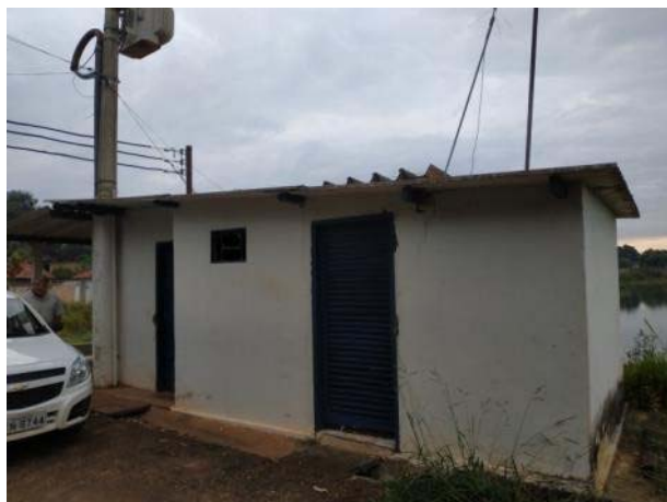
Figura 32. Vista externa da casa de bombas
