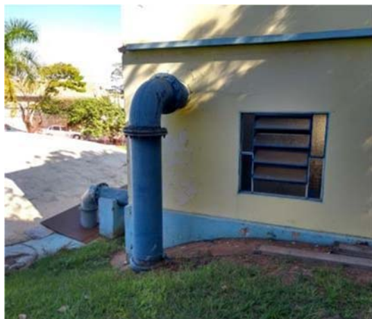
Figura 56. Vista externa da casa de bombas
