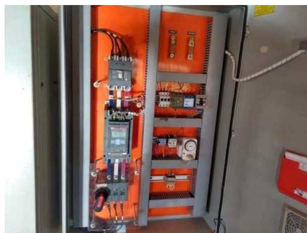
Figura 43. Vista interna do painel destinado ao Poço aeroporto na captação Santa Helena
