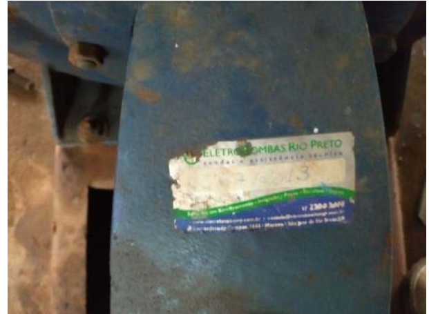
Figura 37. Vista geral da placa de identificação conjunto motor-bomba
