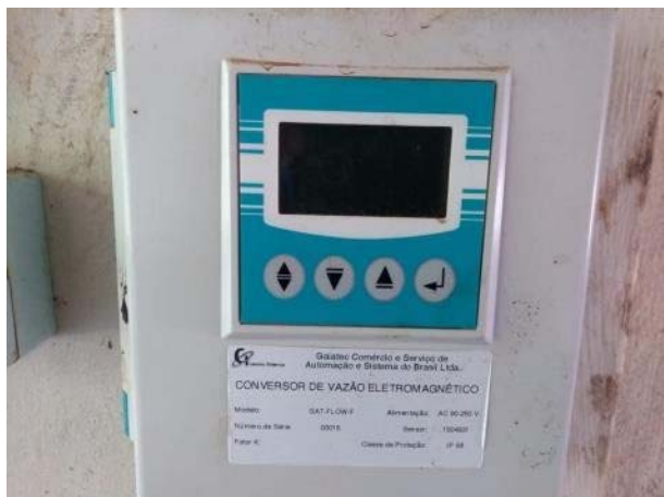
Figura 40. Vista geral do macromedidor de vazão instalado na captação
