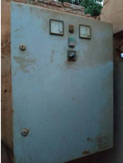
Figura 97. Vista externa do painel elétrico.
